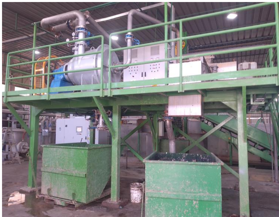
Figura 3.10: Imagen de planta de la etapa de filtración (desfibrador y zaranda)
