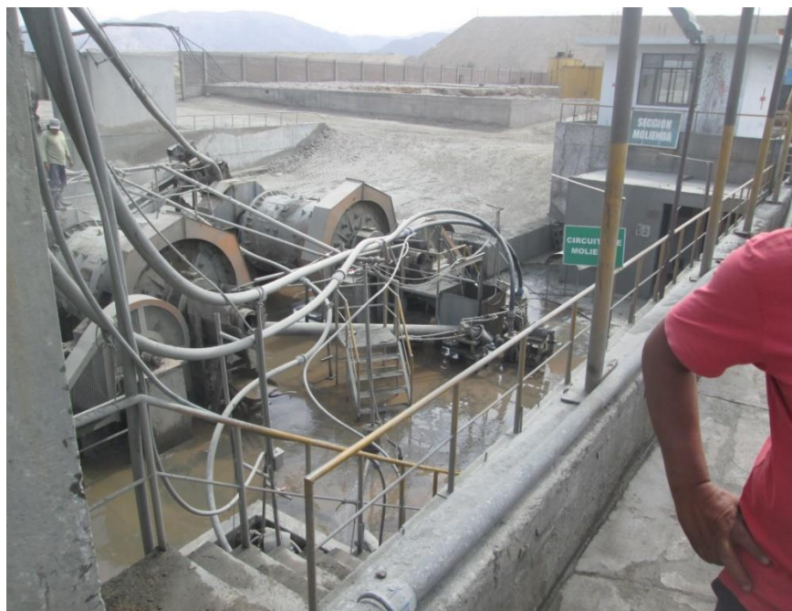
Inundación de tuberías
