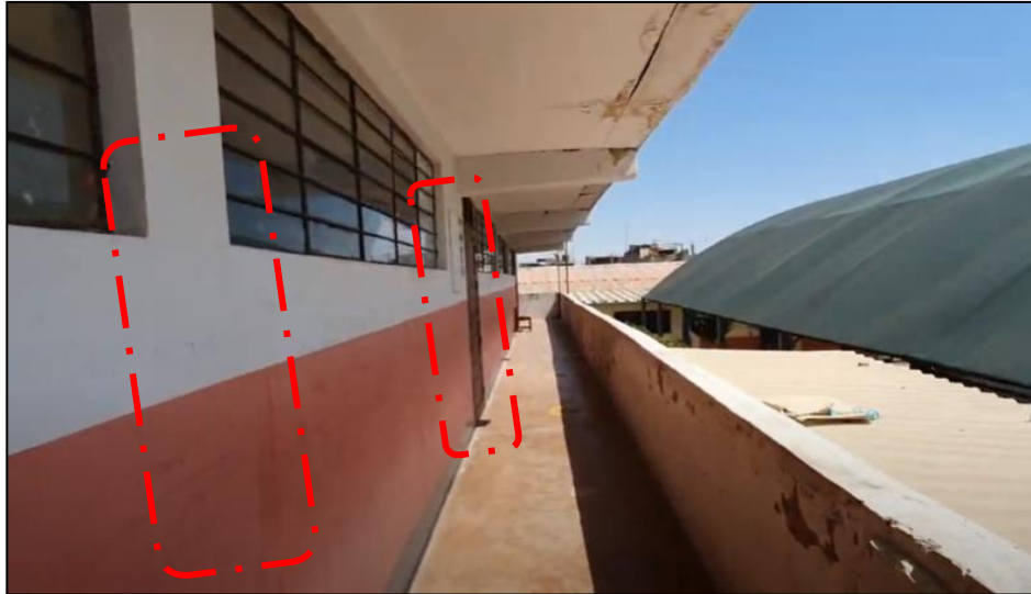
Fig. 11 Inexistencia de juntas de separación de columnas de la tabiquería
