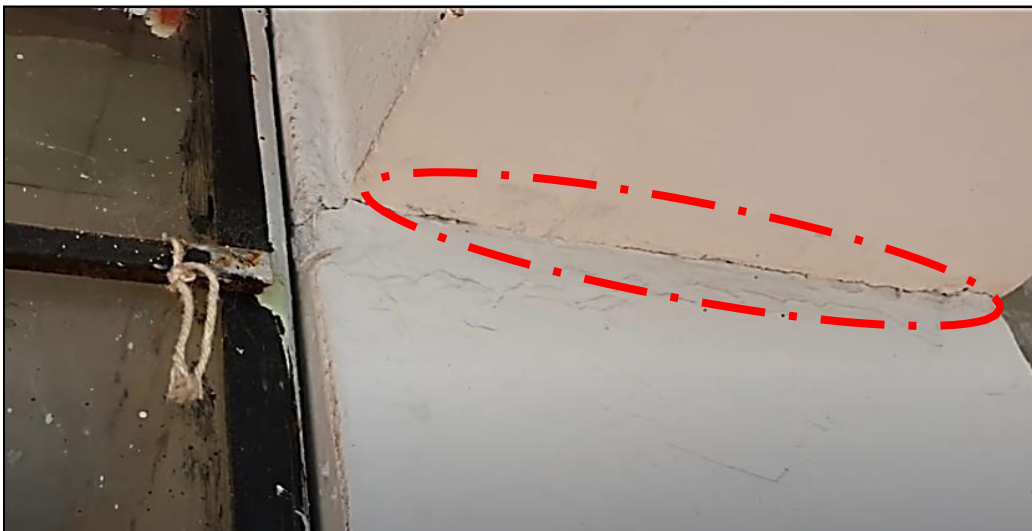
Fig. 27 Fisuras por fallas en conexión de columna-viga
