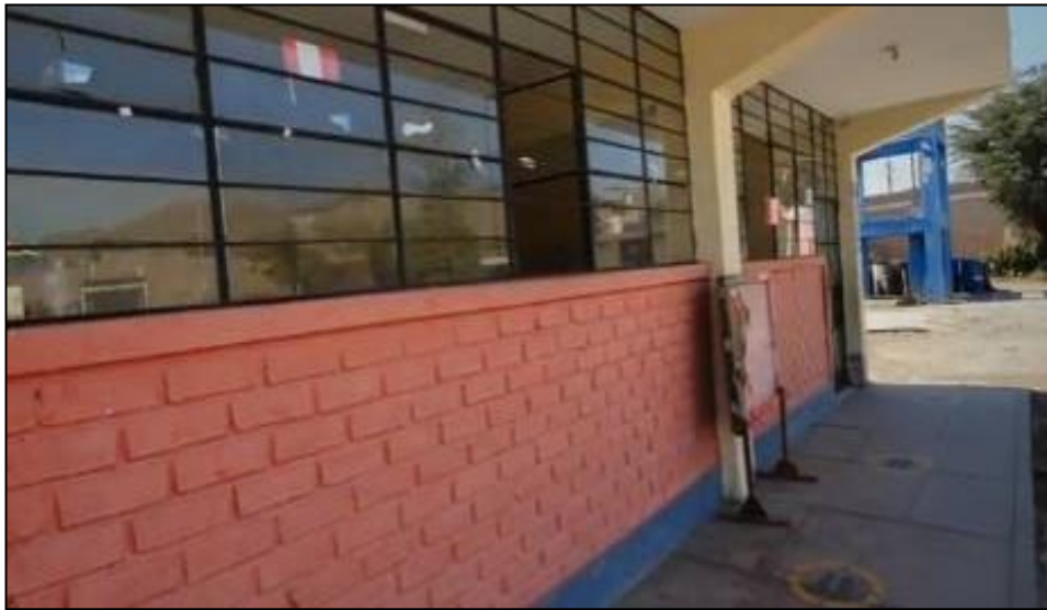
Fig. 23 Estado de conservación pabellón C
