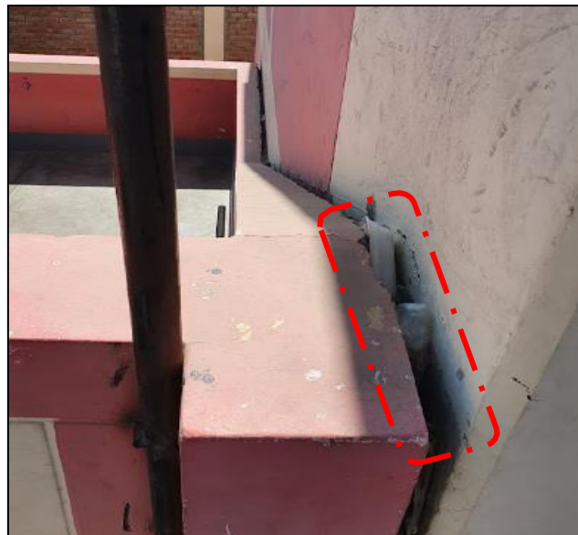
Fig. 22 Estado de conservación pabellón B
