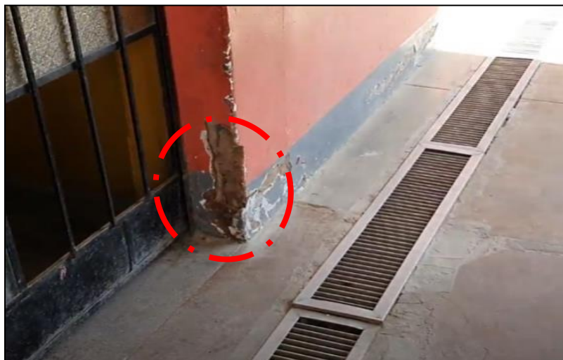
Fig. 29 Desprendimiento de tarrajeo en muros
