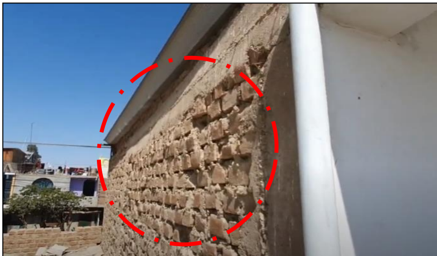
Fig. 12 Muros de albañilería con deficiencias
