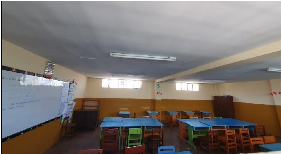
Fig. 7 Estado de conservación primer nivel bloque
