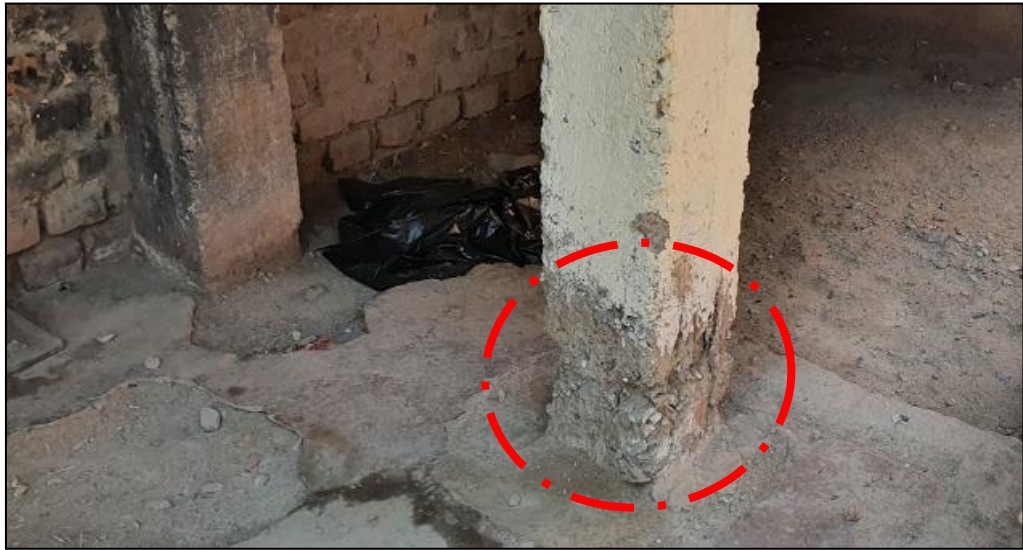
Fig. 26 Desprendimiento del recubrimiento en elementos estructurales de apoyos de escaleras
