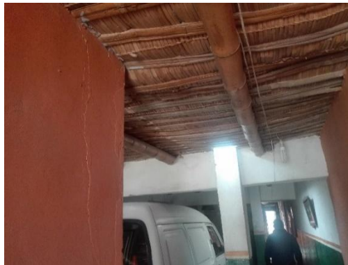
Figura N° 12: Incorrecta unión viga techo
