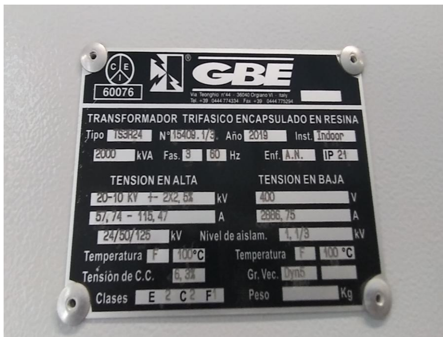
Figura 9 . Placa de Transformadores de Media Tensión
