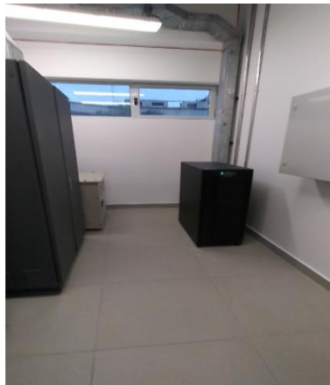
Figura 21 . Banco de Baterías de UPS 60 KVA / UCI Neonatal
