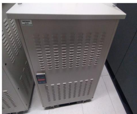
Figura 32 Transformador de Aislamiento 125 KVA - Data Center
