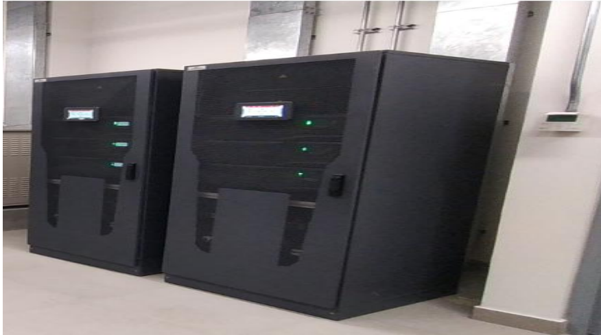
Figura 10 . UPS 160 KV Zona Servicios Generales
