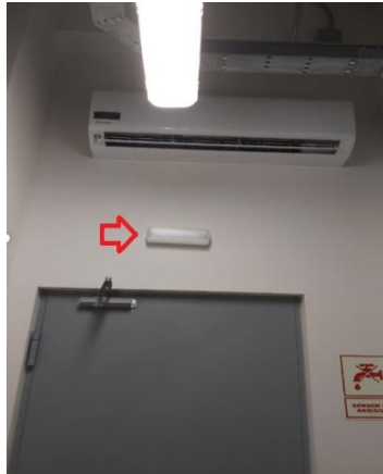
Figura 71 instalación de Luminarias de Emergencia Interiores EVOLUTION NP LED 1.5H 400 LUM
