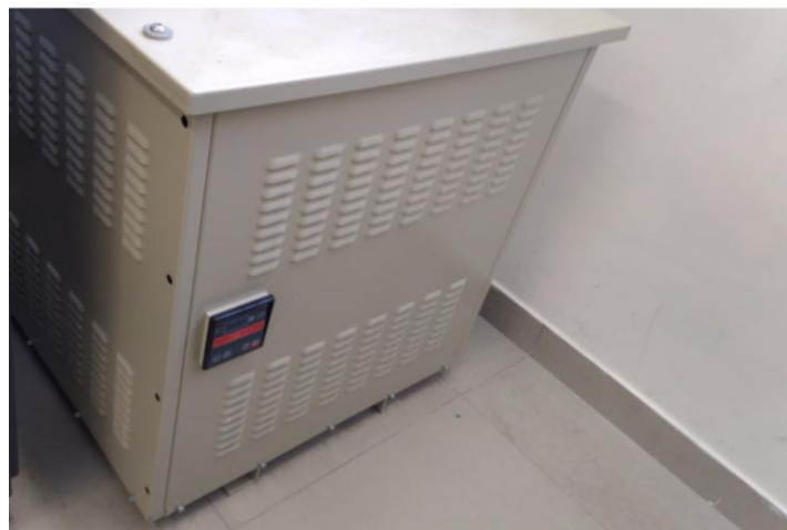
Figura 36 Transformador de Aislamiento 25 KVA - Sala de Partos
