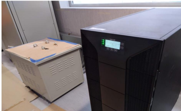
Figura 35 Transformadores de Aislamiento 25 KVA - Corredor Técnico
