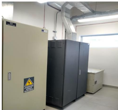
Figura 18 . Banco de Baterías UPS 60 KVA
