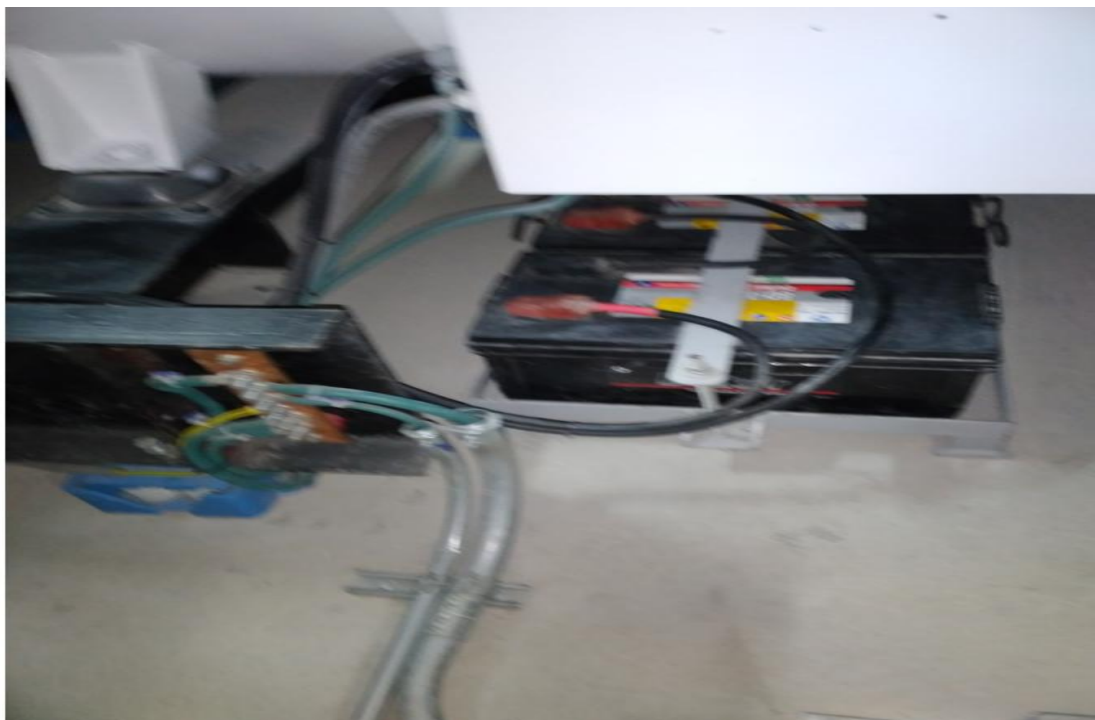
Figura 113 . Instalación y Conexionado de Baterías Delkor Modelo 8D-1300 de GE
