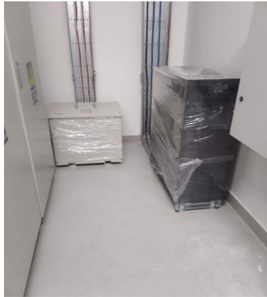
Figura 37 Transformador de Aislamiento 12.5 KVA - Centro Quirúrgico
