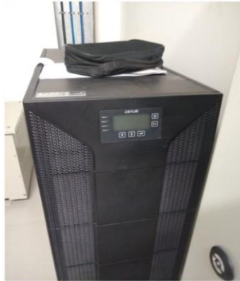
Figura 25 . UPS 10 KV Zona Centro Quirúrgico
