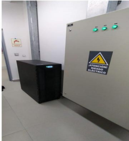
Figura 27 UPS 10 KV Zona Diagnóstico Por Imagen
