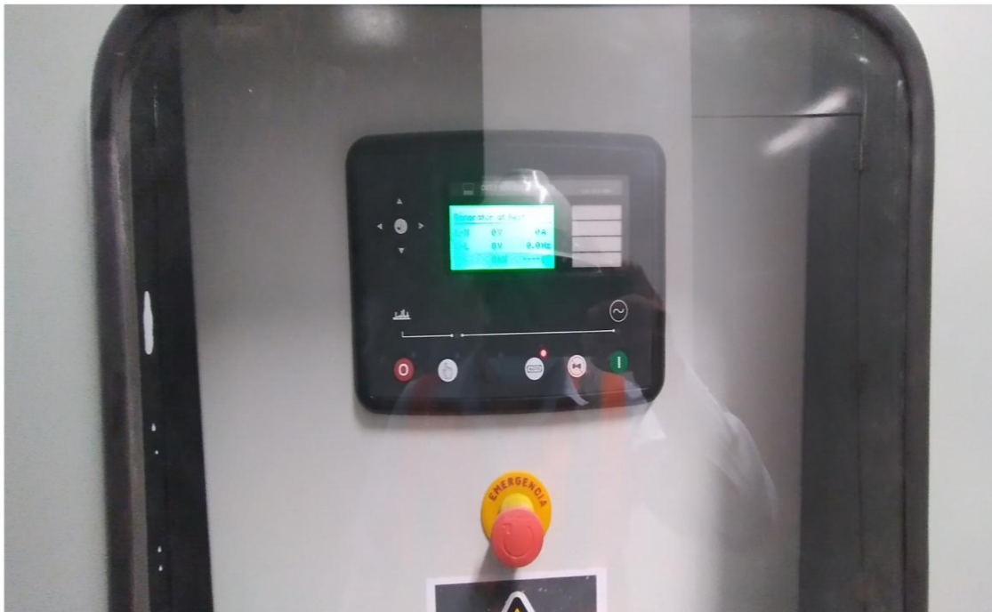
Figura 115 . Panel de Control DSE 8610 de Grupo Electr6geno 1800KVA
