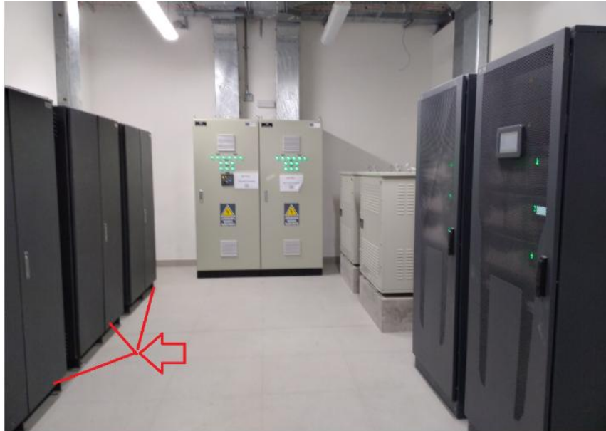
Figura 12 . Banco de Baterías UPS 160KVA
