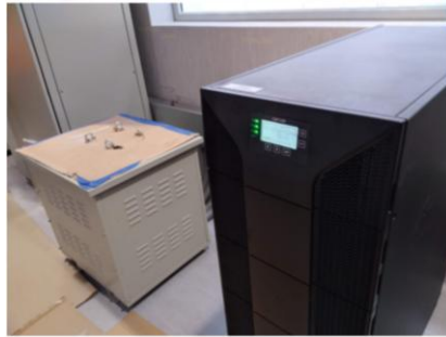
Figura 22 . UPS 20 KV Zona Corredor Técnico de Quirófanos
