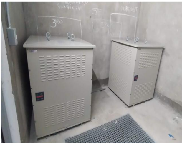
Figura 30 Transformador de Aislamiento 225 KVA - Intervencionismo y Neurocirugía
