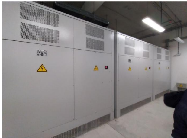
Figura 6 . Transformadores de Media Tensión Exterior
