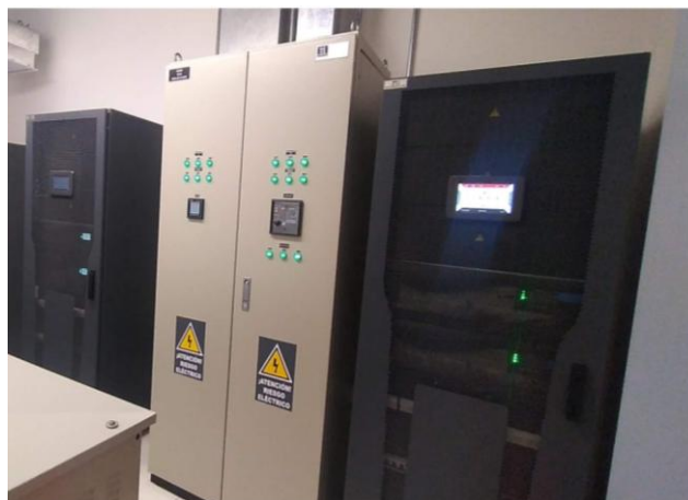
Figura 13 . UPS 100KV Zona Data Center
