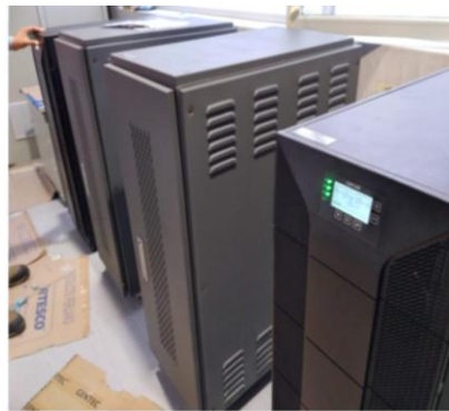
Figura 24 . Banco de Baterías de UPS 20 KVA / Corredor Quirófanos
