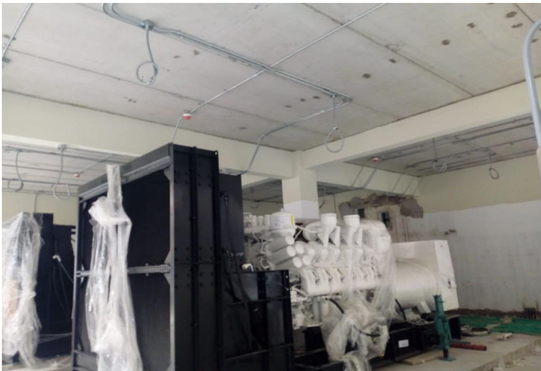
Figura 111 . Acople de Motor Generador y Radiador de GE 1800KVA
