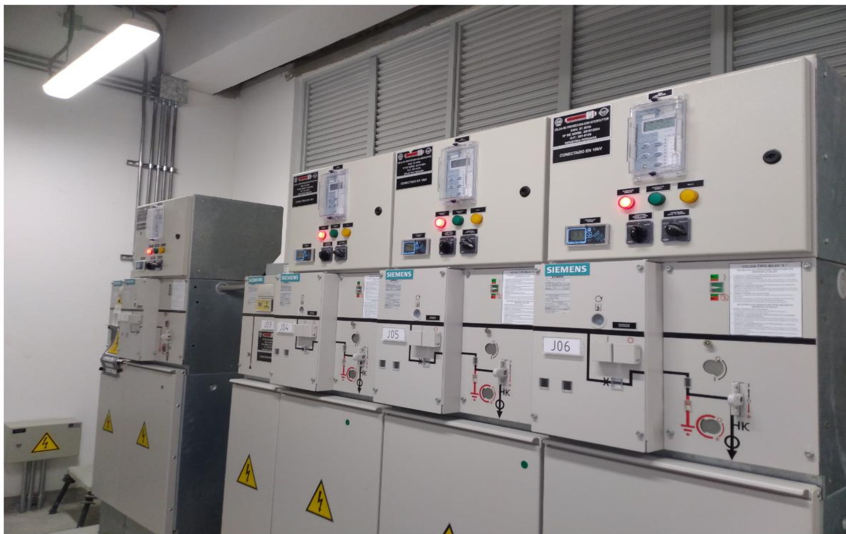
Figura 95 . Celdas de Media Tensión Instaladas en Obra.
