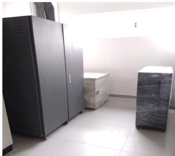
Figura 34 Transformador de Aislamiento 75 KVA - UCI Neonatal.
