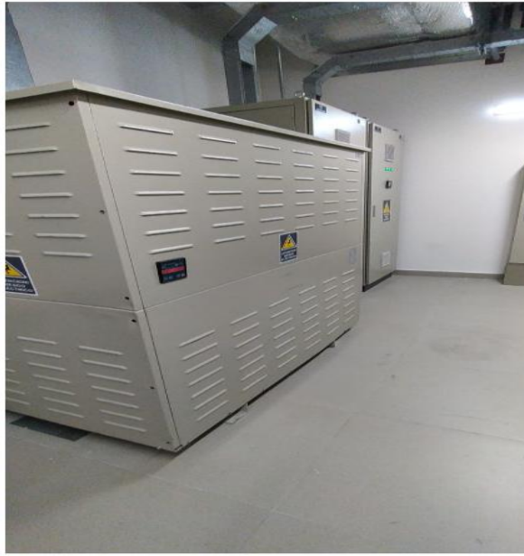
Figura 29 Transformador de Aislamiento de 800 KVA - Montante A
