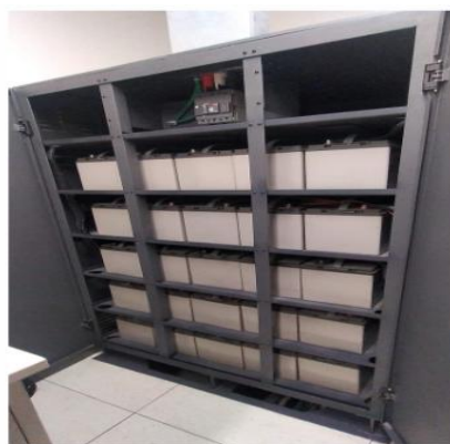
Figura 15 . Banco de Baterías UPS 100 KVA
