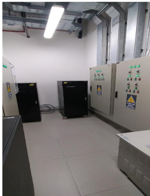
Figura 38 Transformador de Aislamiento 12.5 KVA-Diagnóstico por Imagen
