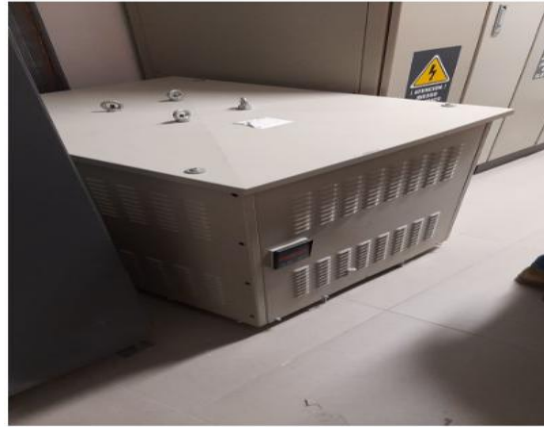
Figura 33 Transformador de Aislamiento 75 KVA - UCI Neonatal.
