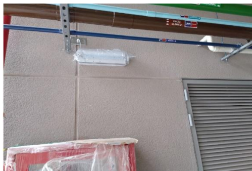
Figura 72 Instalación de Luminarias de Emergencia exteriores Emerlight Led 6 W, 440 Lm
