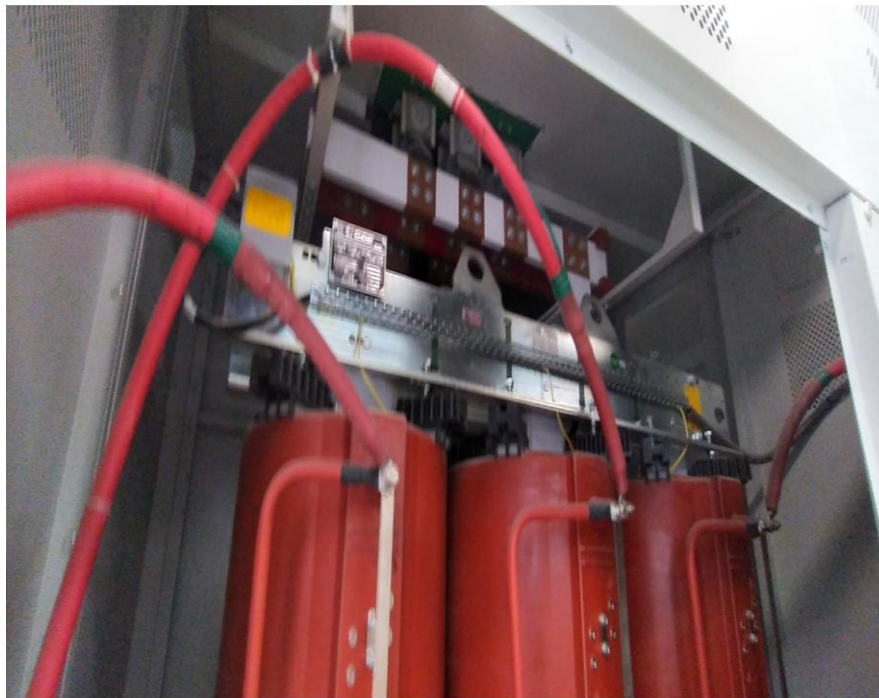
Figura 8 . Parte Interna de Transformador de Media Tensión
