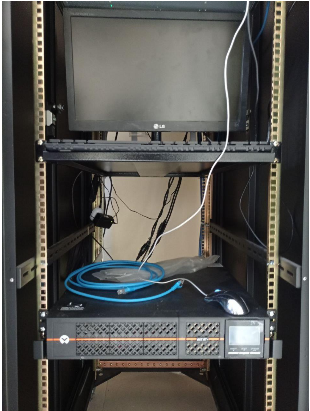
Fig. 26. Gabinete piso de comunicaciones
