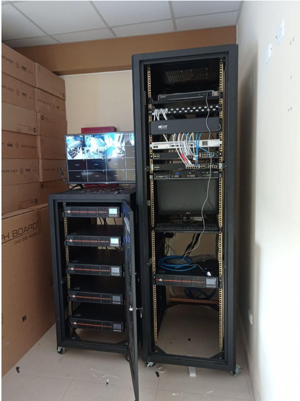
Fig. 29. Gabinetes de comunicaciones y monitoreo
