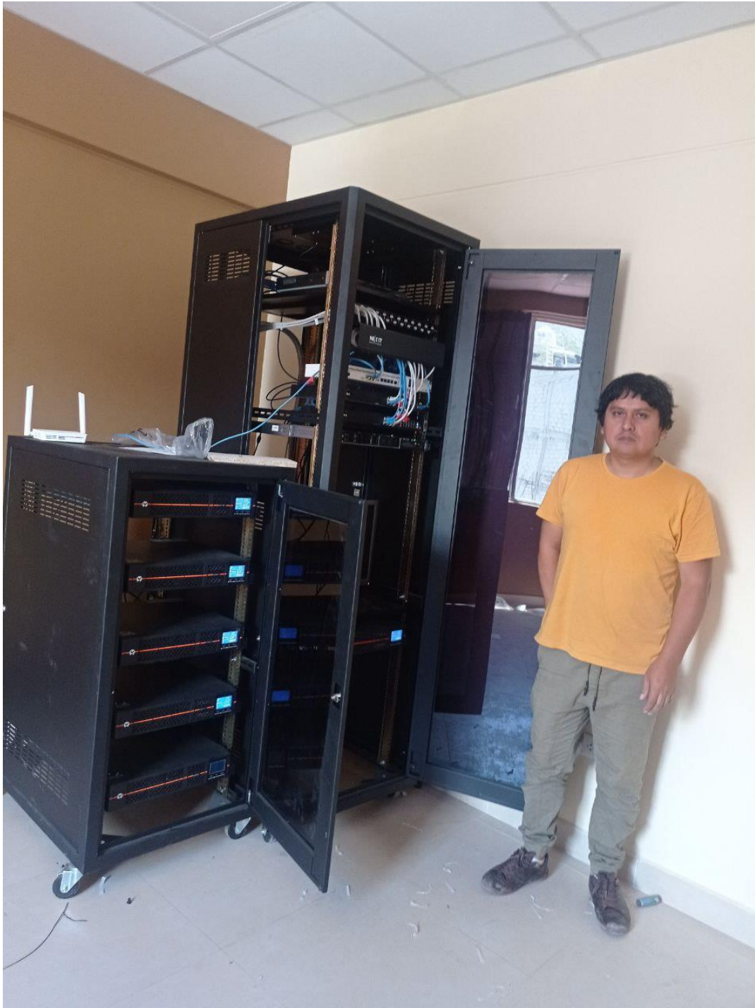
Fig. 33. Gabinetes de comunicaciones instalado
