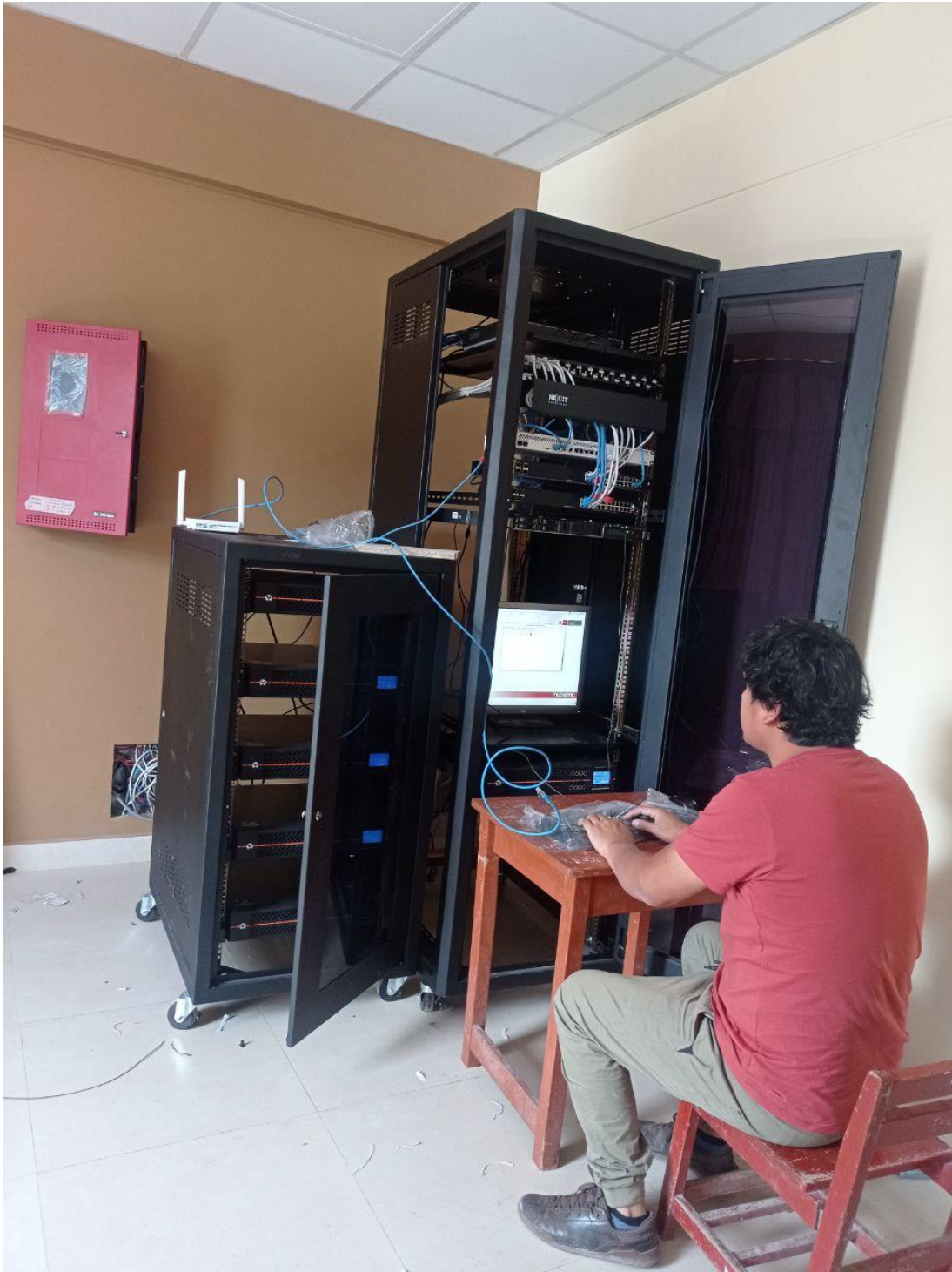
Fig. 35. Verificación de la conexión del gabinete.
