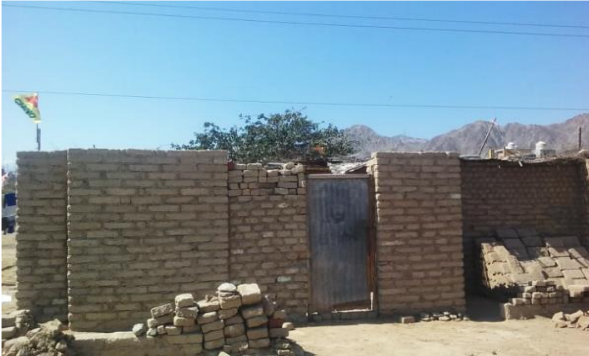
Figura 66: Estado de precariedad de una vivienda con material de construcción de adobe
