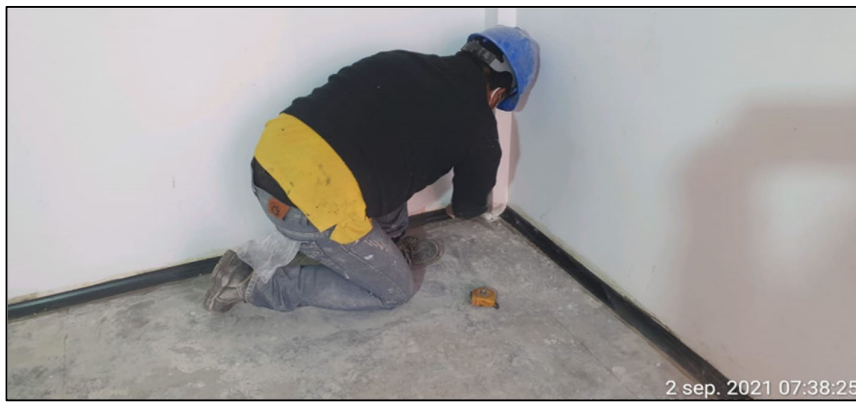
Fig. 135 Instalación de piso antiestático en Sala de Equipos – colocación de soporte de zócalo
