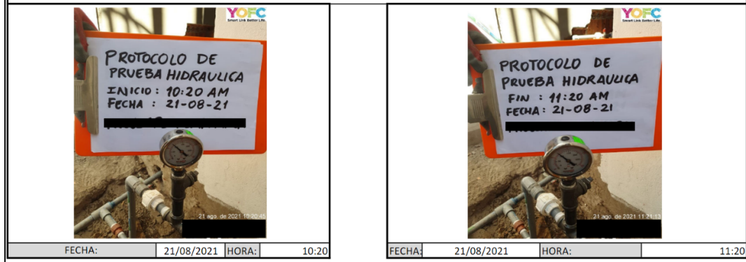
Fig. 151 Protocolo de Presión Hidráulica
