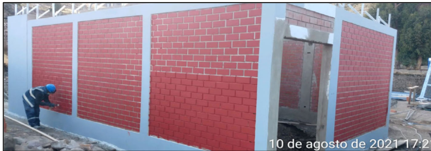
Fig. 119 Pintado Exterior de Muro lateral izquierdo de Cerco perimétrico y Sala de Equipos
