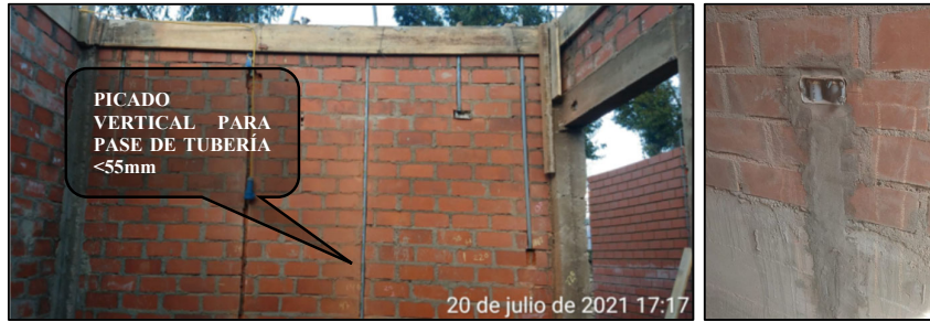
Fig. 79 Detalle de tubería en muro de sala de equipo
