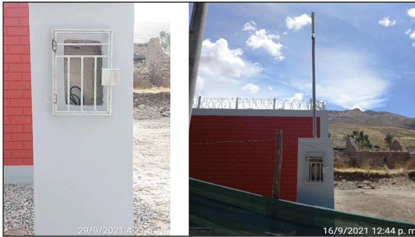
Fig. 162 Vista Murete de medidor
