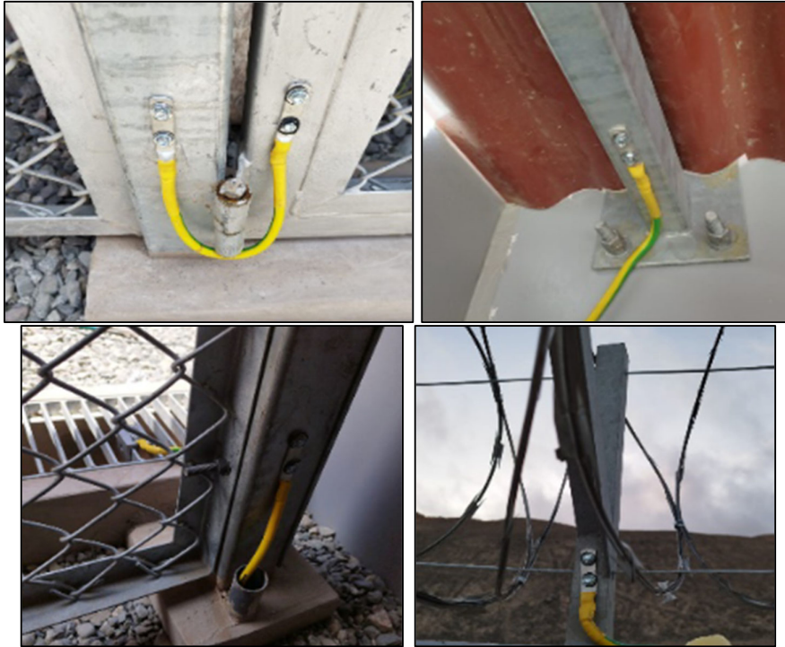
Fig. 145 Aterramiento en estructura metálicas
