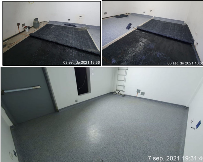
Fig. 137 Instalación de piso antiestático en Sala de Equipos – colocación de piso vinílico
