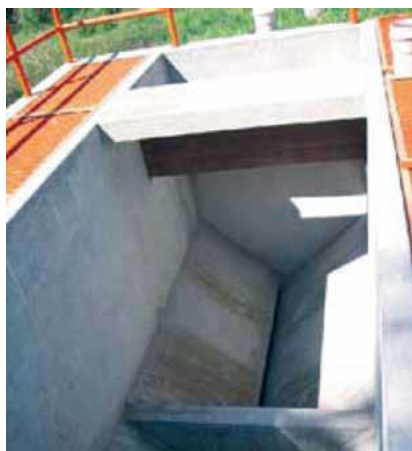
Figura 4: Tanque Imhoff vista superior
