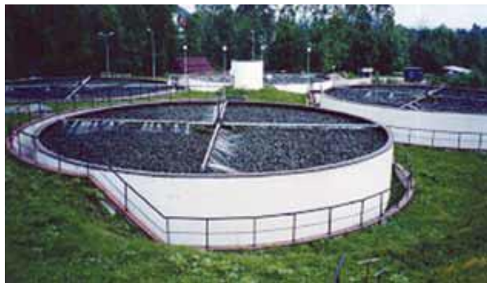
Figura 5: Vista panorámica de una batería de filtros percoladores.
