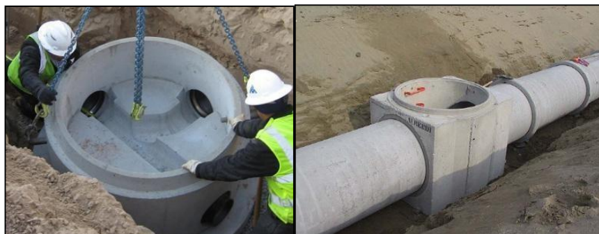
Fig. 3: Cámara de inspección
