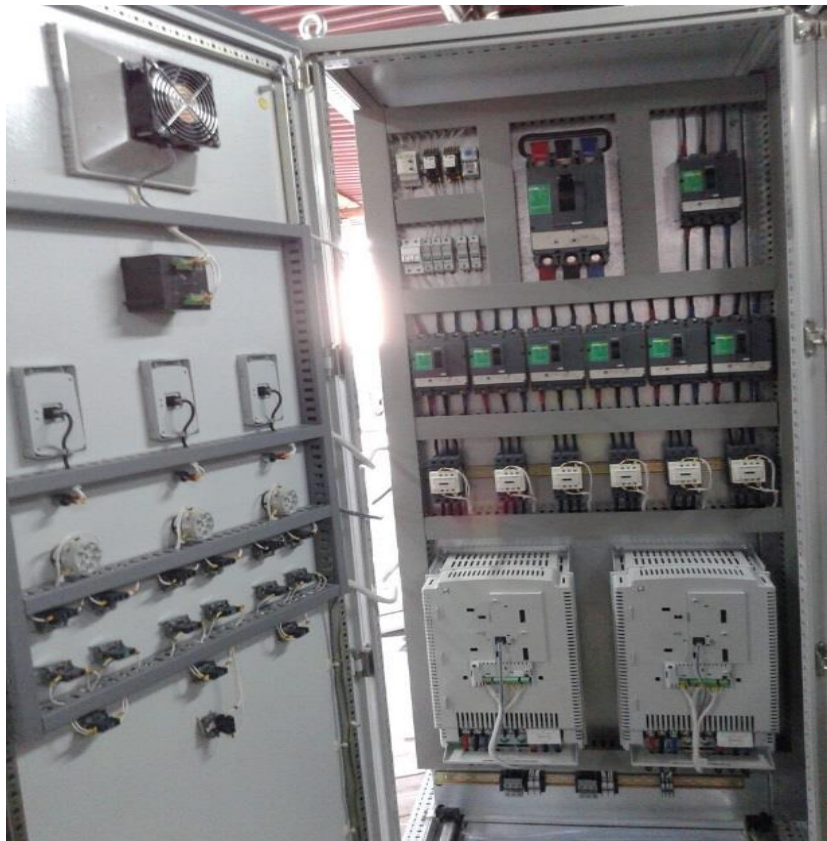
Fig. 19: Presentación de orden de cableado lógico y fuerza en tablero auto soportado
