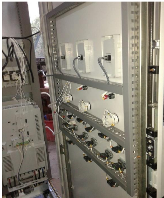
Fig. 17: Conexión de display con variadores de frecuencia
