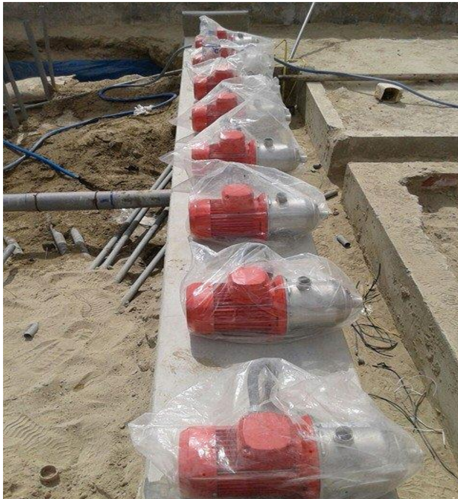
Fig. 20: Posicionamiento de motores para sala de rebombeo
