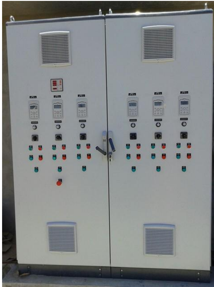
Fig. 11: Presentación final tablero auto soportado con 06 variadores de frecuencia
