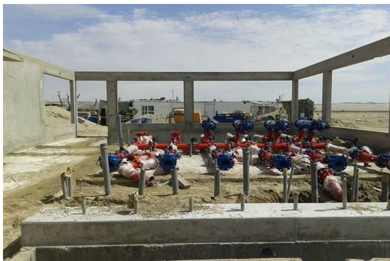
Fig. 4: Sala de bombeo nueva sistema de riego agrícola SAFCO
