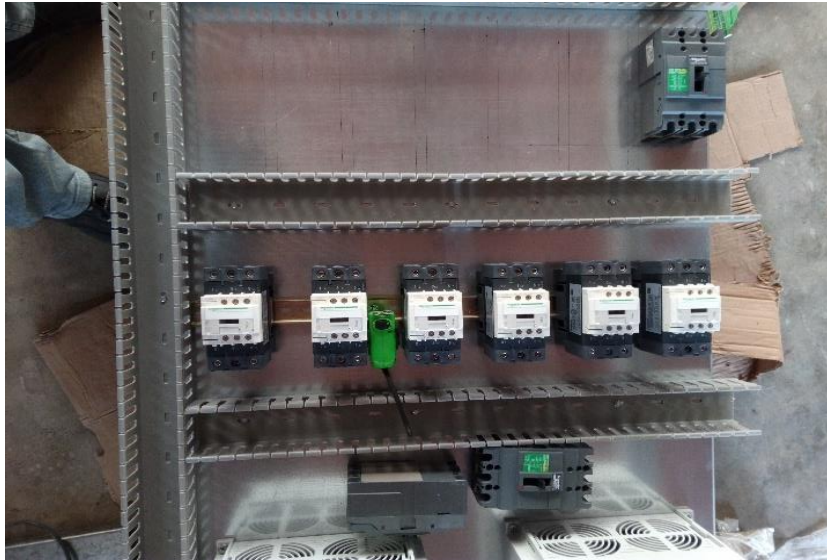
Fig. 13: Contactores p/variadores en tablero auto soportado
