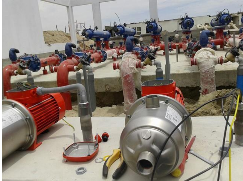
Fig. 21: Apertura de borneras para conexionado en motores
