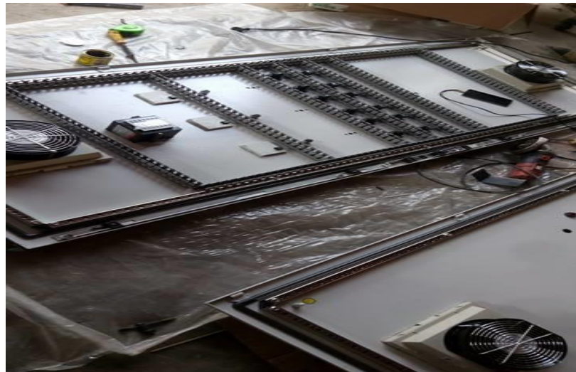
Fig. 14: Canalización de tablero auto soportado
