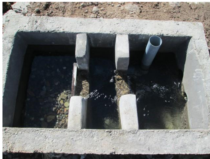
Figura 3. Desarenador de agua 2.
