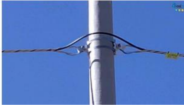
Herraje de retención instalado
