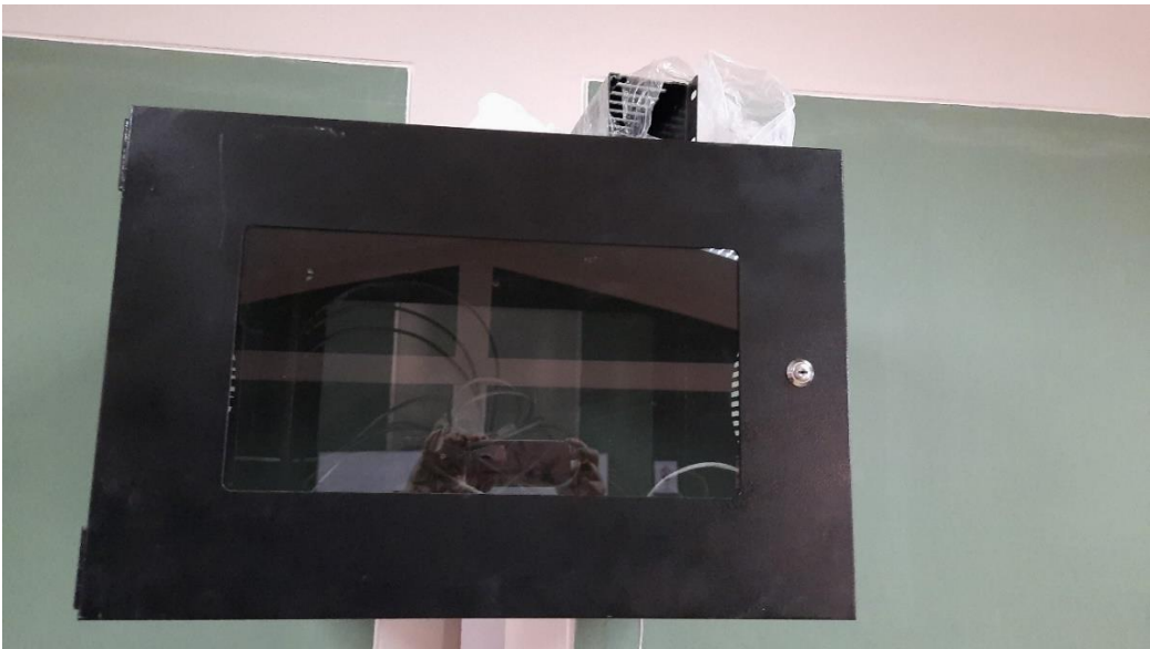
Fig. 26. Gabinete con equipos de comunicaciones
