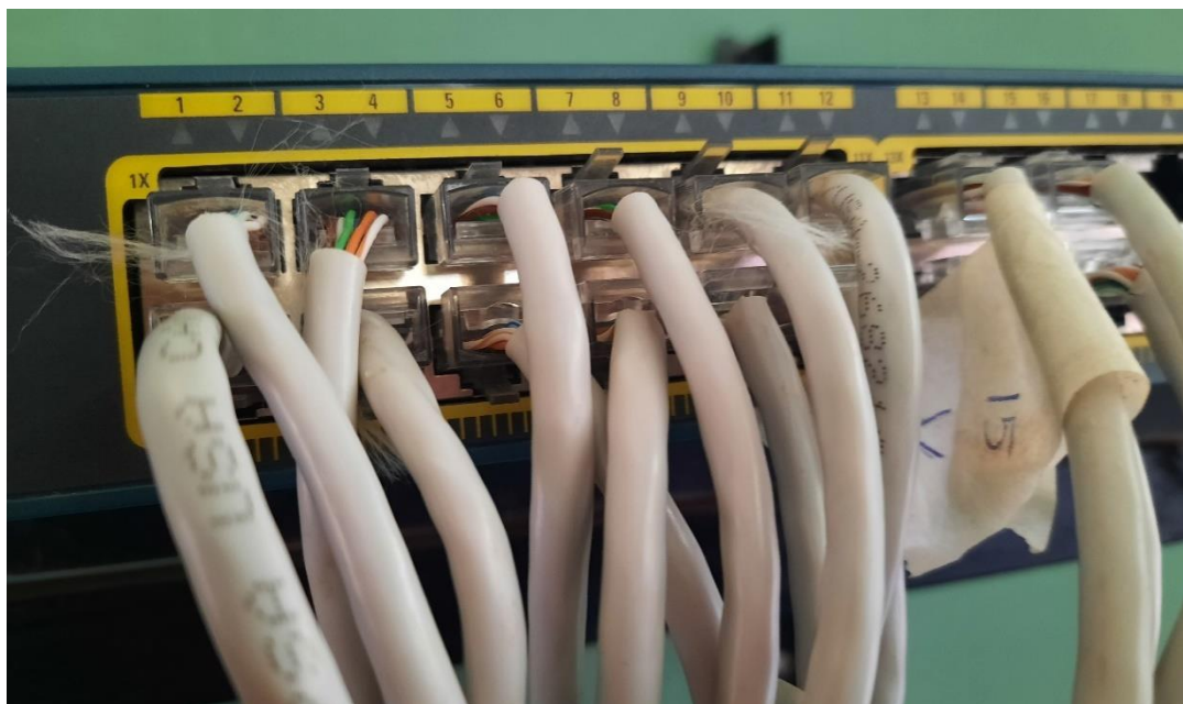
Fig. 7. Estado del cableado hacia el switch
