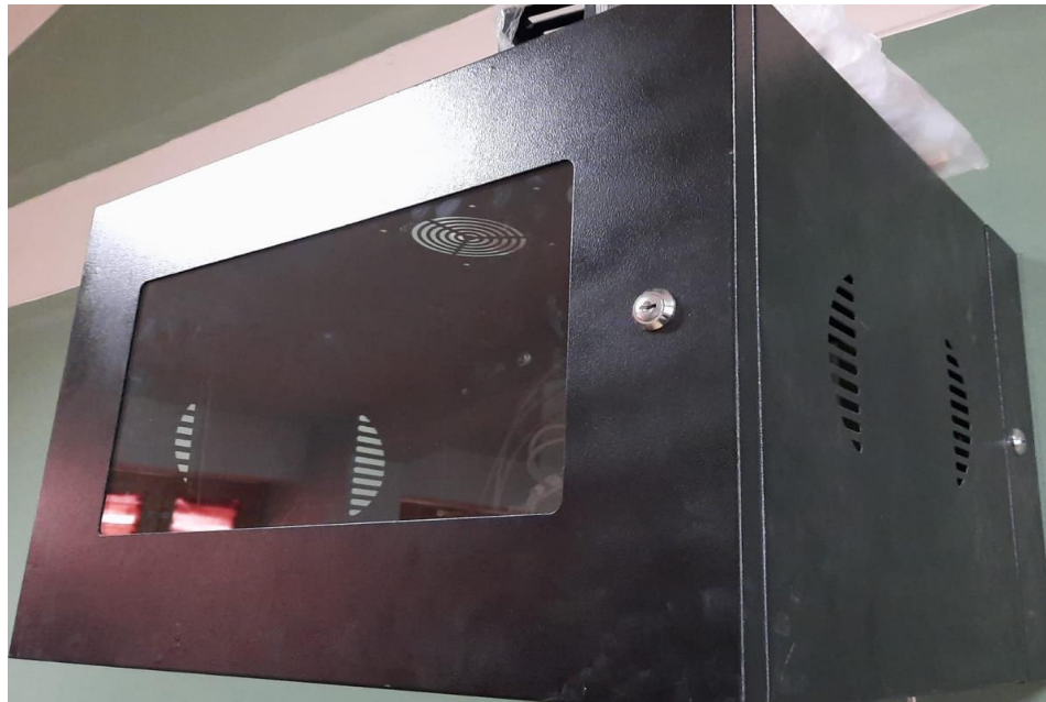
Fig. 21. Gabinete de comunicaciones
