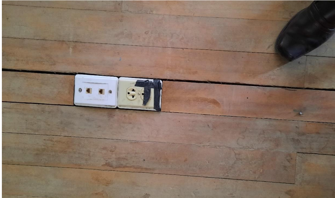
Fig. 13. Estado de la conexión de energía
