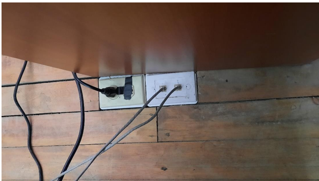
Fig. 33. Cableado vertical por debajo del piso
