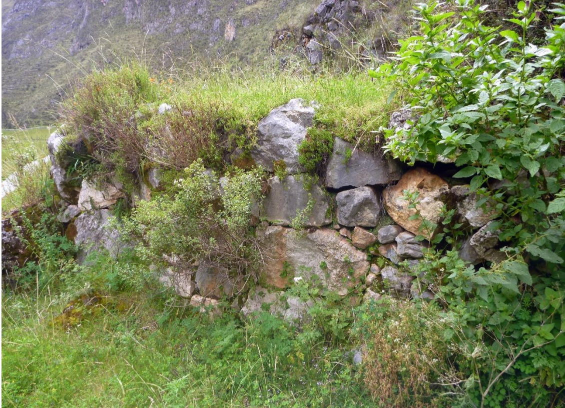
Foto 51: Muro de contención recto, que posiblemente corresponde a una restitución contemporánea. Fuente: Franclyn Jayo; 2022
