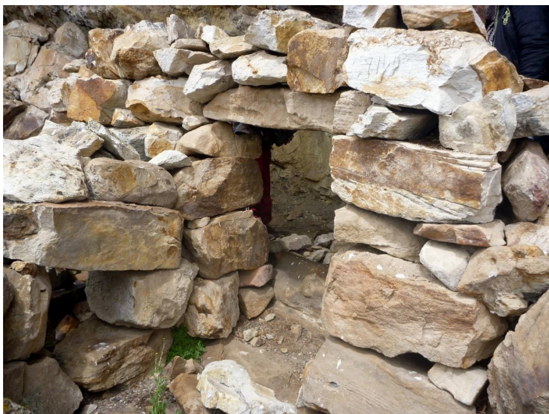
Foto 40: Vista de detalle del vano de acceso y de la construcción sin uso de argamasa. Fuente: Franclyn Jayo; 2022
