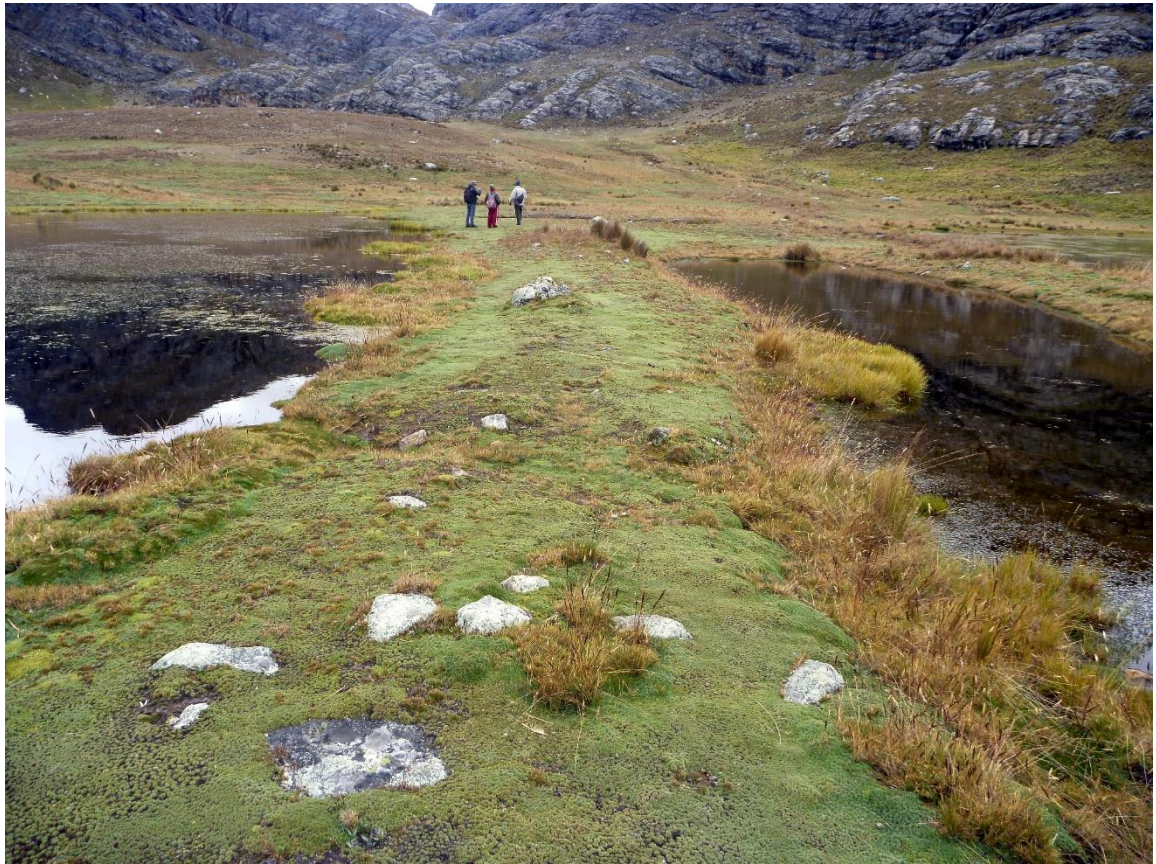
Foto 43: Vista del dique, cuya superficie se observa sobre elevada en relación a la acumulación de agua. Fuente: Franclyn Jayo; 2022
