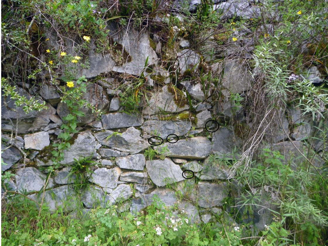
Foto 68: Pachillas en el paramento del muro de contención de un andén del primer sector. Fuente: Franclyn Jayo; 2022
