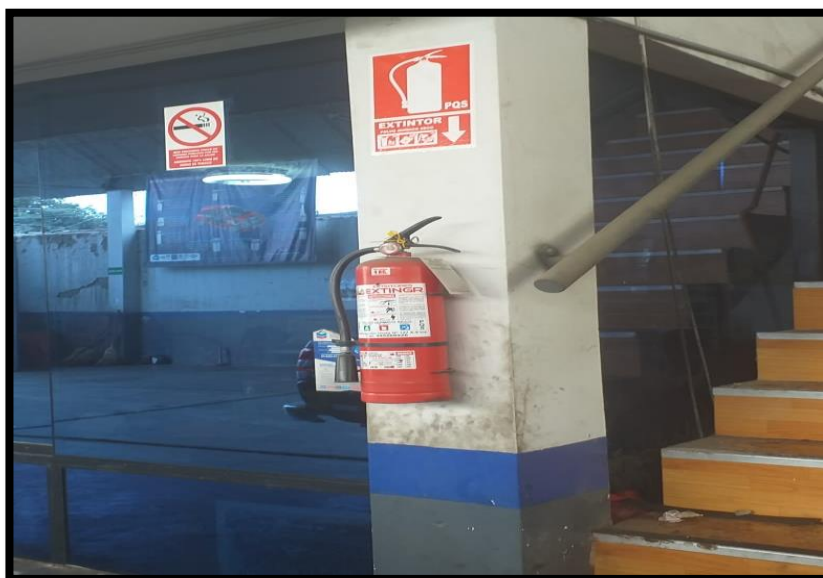
EXTINTOR CON SEÑALÉTICA
