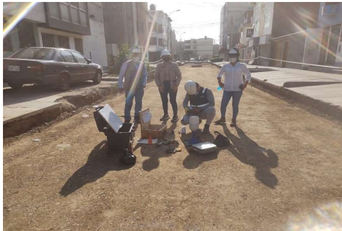
Fotografía 5. Verificación en campo de avance de obra y cumplimiento de ensayos de campo
