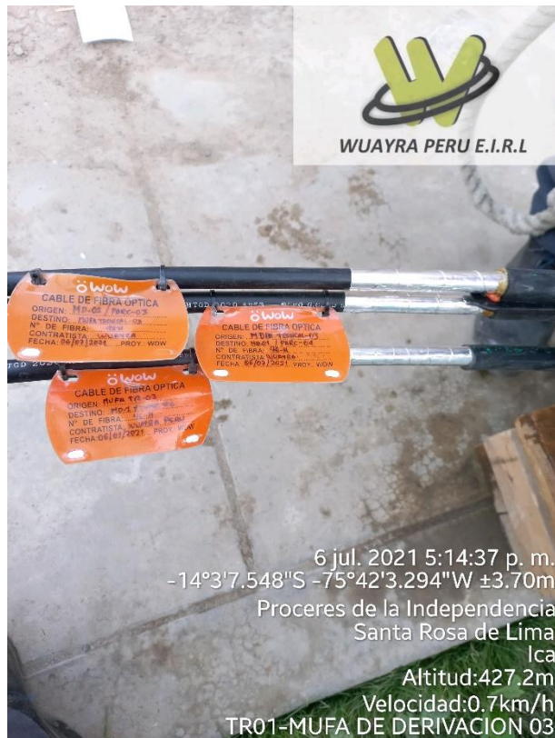
Figura N°12: Etiquetas de cable FO de ingreso y salida a la mufa del poste 3.
