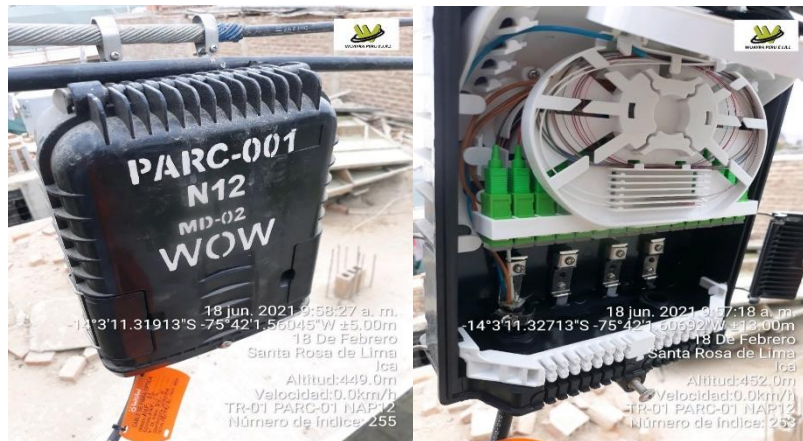
Figura N°27: Vista frontal del NAP (izquierda) y vista frontal de empalmes (derecha).
