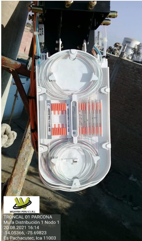
Figura N°7: Vista frontal de la primera bandeja de FO del poste 1.
