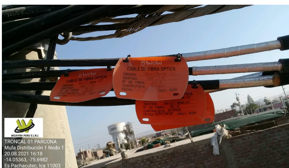
Figura N°6: Etiquetas de cables FO de ingreso y salida a la mufa del poste 1.
