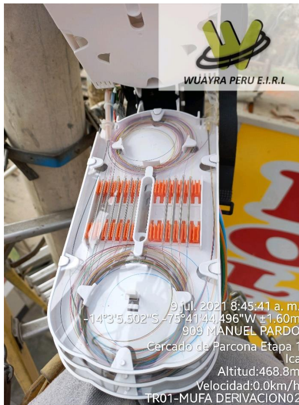
Figura N°10: Vista frontal de la primera bandeja de FO del poste 2.
