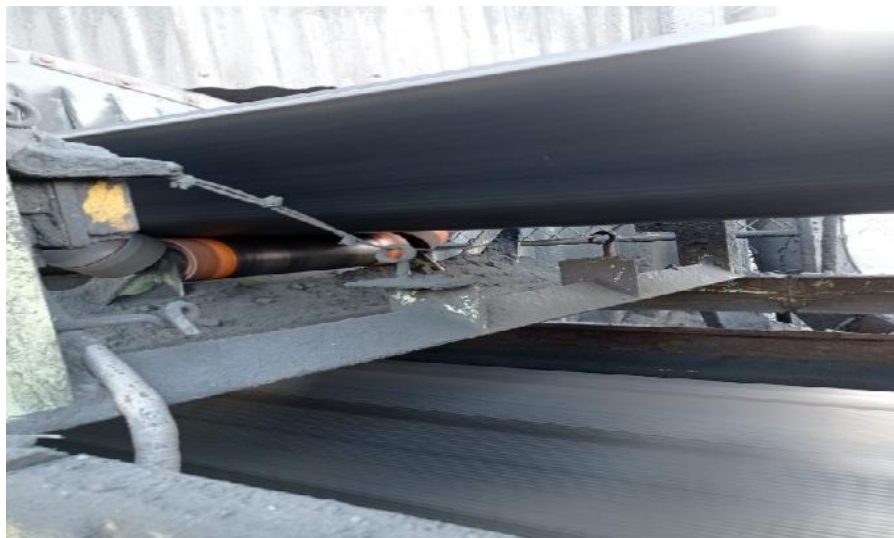
Fig. 14. Interruptor de ruptura de faja
