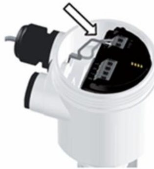
FIG. 1 Desconexión de sensor tipo radar
