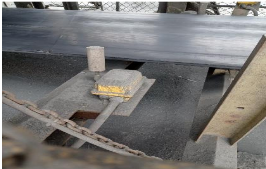
Fig. 10. Switch de desalineamiento
