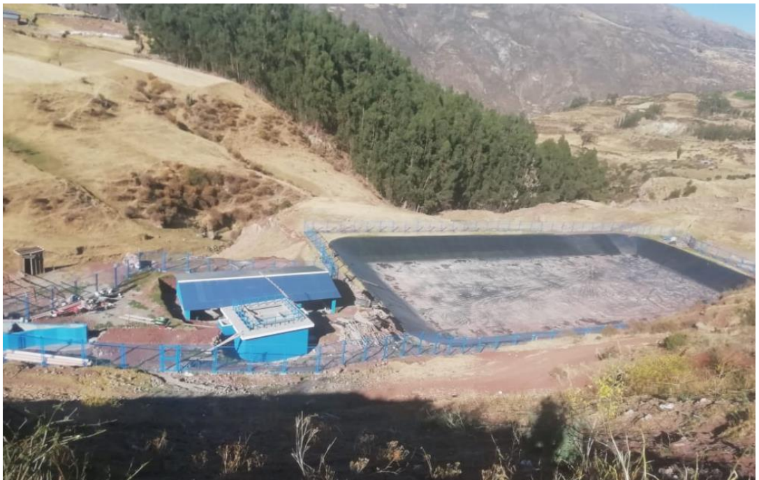
Figura 7 Piscina – “Humedal de flujo subsuperficial” - Distrito Lucanas
