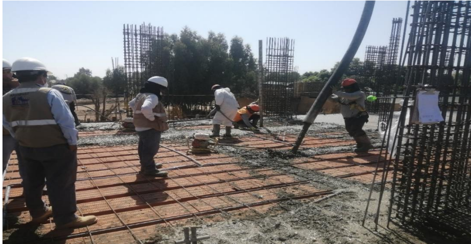
Vaciado de concreto en losa aligerada del 2do piso en el sector 01.
