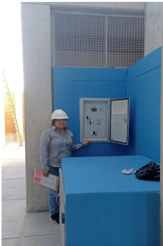
Vista del tablero eléctrico del elevador vertical.
