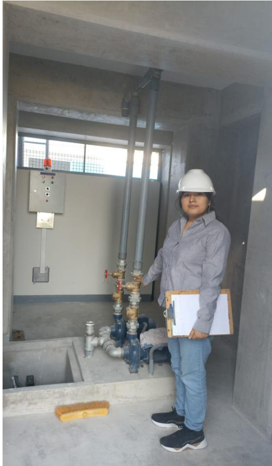
Vista actual del árbol hidráulico en el cuarto de máquinas.
