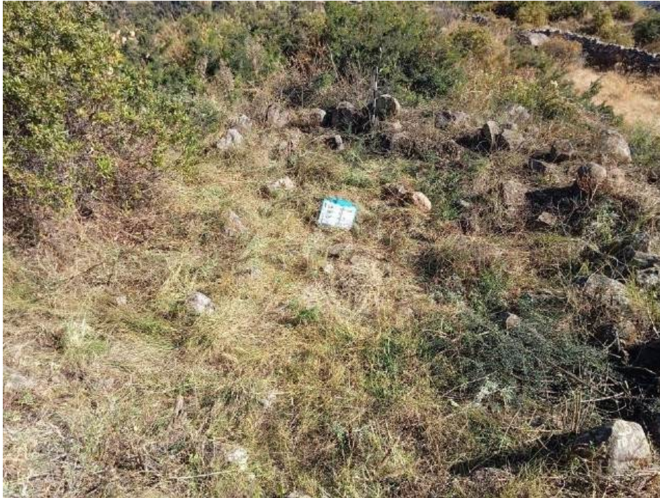
Figura 61: estructura con un nivel alto de mala conservación, se observa el derrumbe de todo el muro.
