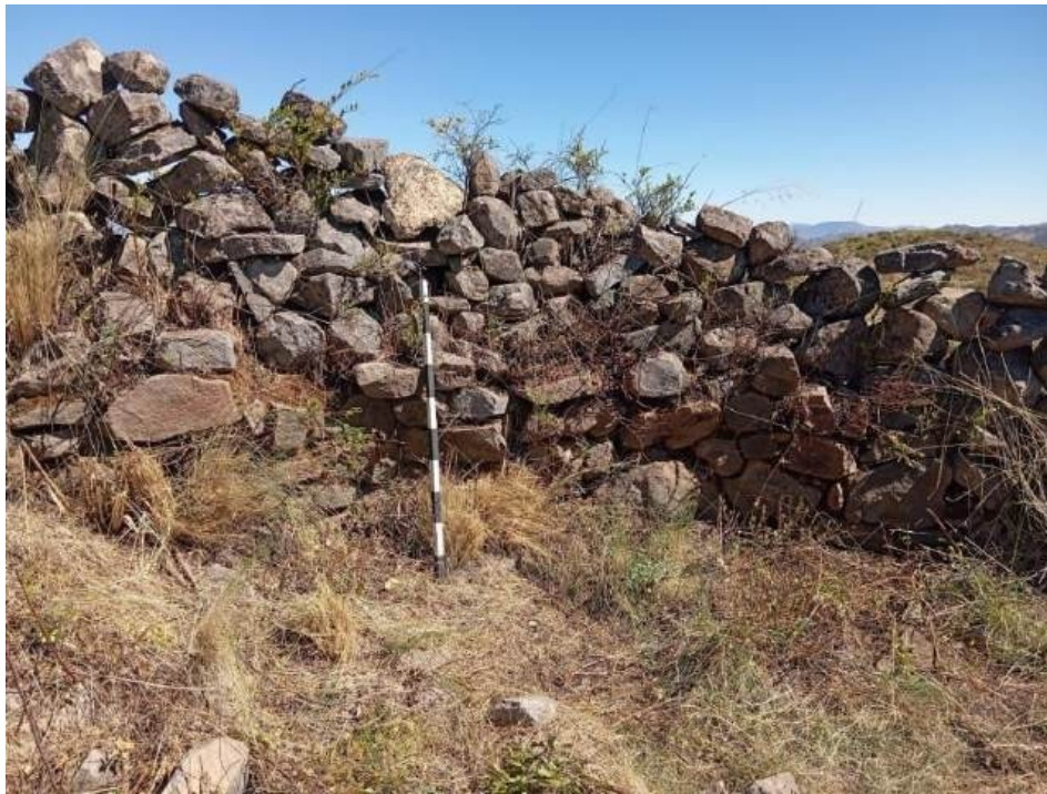
Figura 46: el muro antiguo a sido reutilizado para un muro actual, se observa la diferencia, el antiguo con argamasa y el actual sobrepuesto uno sobre otro. Fuente: M.R.C.
