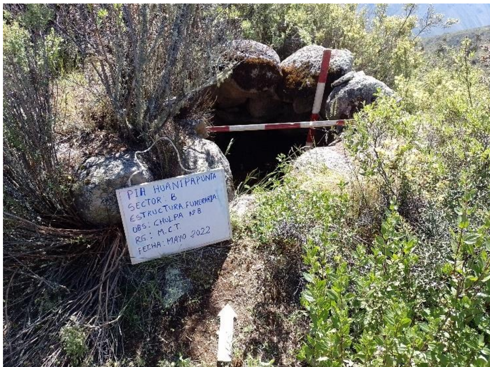
Figura N° 27: Vista de detalle del recinto funerario N° 8 (chullpa N° 8), donde muestra el colapso del techo. (Foto Martin Claudio 2022).
