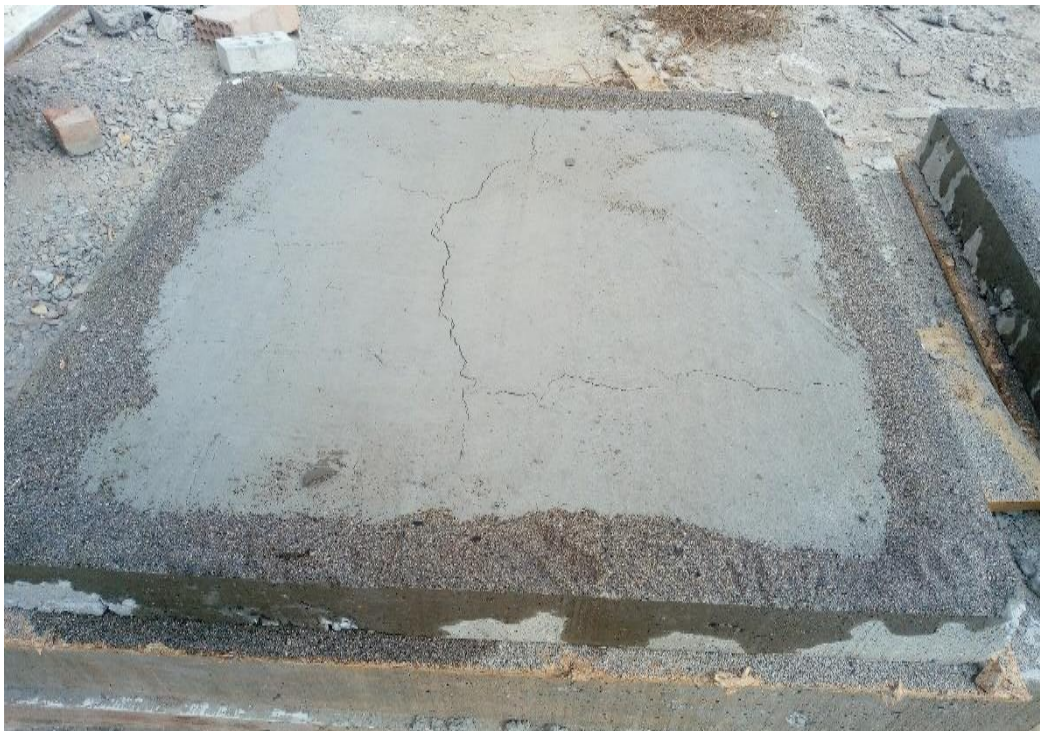
Figura 58 Aparición de fisuras en losa elaborada a una temperatura ambiental promedio alta (22°C) a horas 12:00 pm
