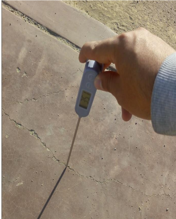
Figura 71 Presencia de fisuras en vereda y registro de temperatura de la vereda (35.1°C) a una temperatura ambiental de 28°C
