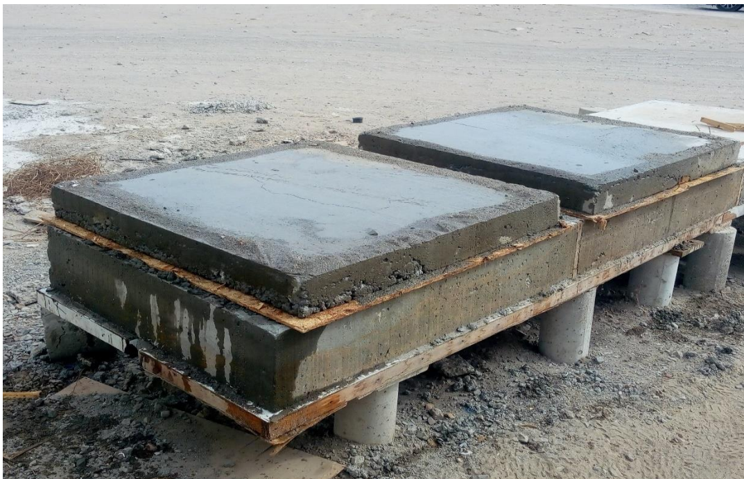
Figura 62 Aparición de cangrejas y fisuras en losas fabricadas a temperatura ambiental promedio alta (30°C) a horas 12:00 p.m.
