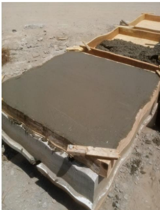
Figura 55 Fabricación de losa de concreto a una temperatura ambiental promedio alta (30°C)
