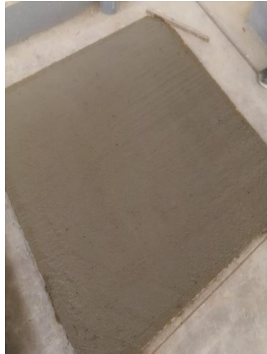
Figura 54 Losa fabricada a una temperatura ambiental promedio (22°C)
