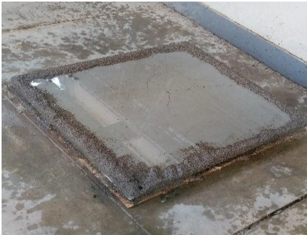
Figura 60 Aparición de fisuras en losa elaborada a una temperatura ambiental promedio (22°C) a horas 08:30 am
