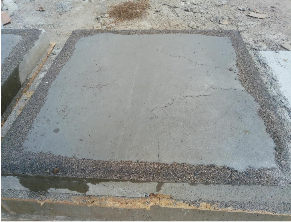
Figura 57 Aparición de fisuras en losa elaborada a una temperatura ambiental promedio alta (30°C) a horas 12:00 pm
