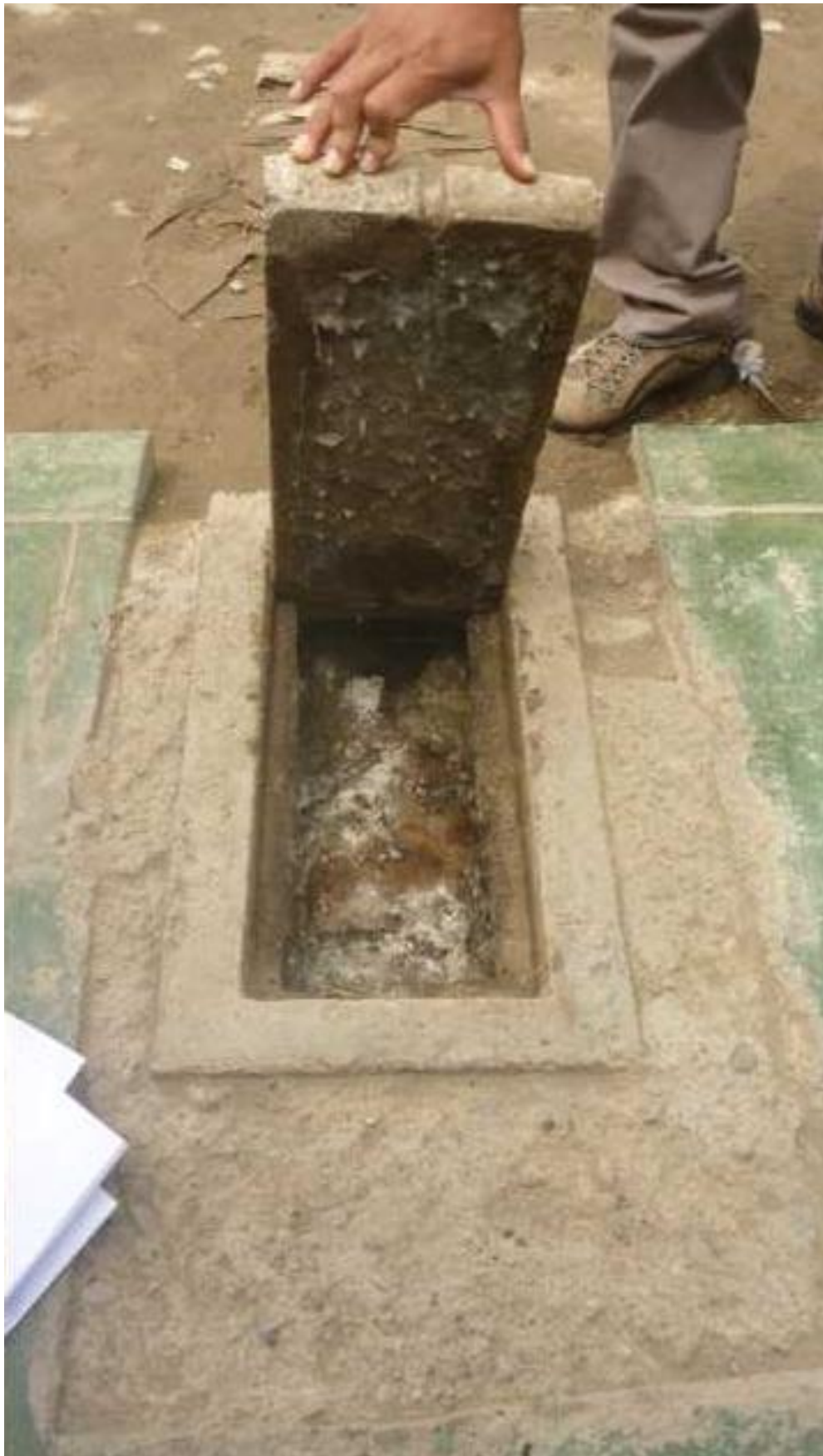
Fig. 10 Vista de una conexión domiciliar de desagüe colmatada
