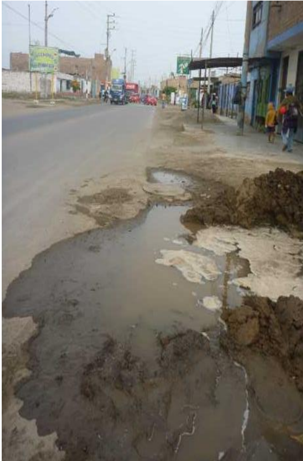
Fig. 2 Rebose de buzones existentes
