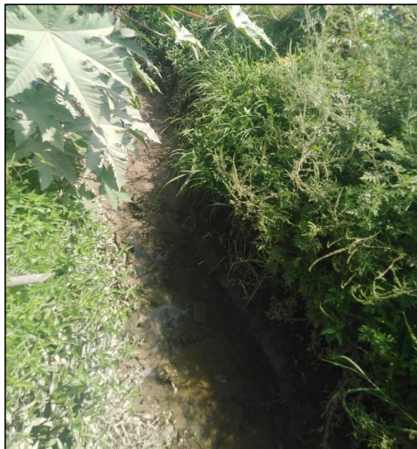
Fig. 14. Deformación del canal y depósitos de desperdicios en el fondo
