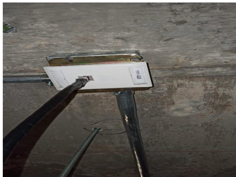
Nota: Toma de punto de red que se conecta a la cámara
