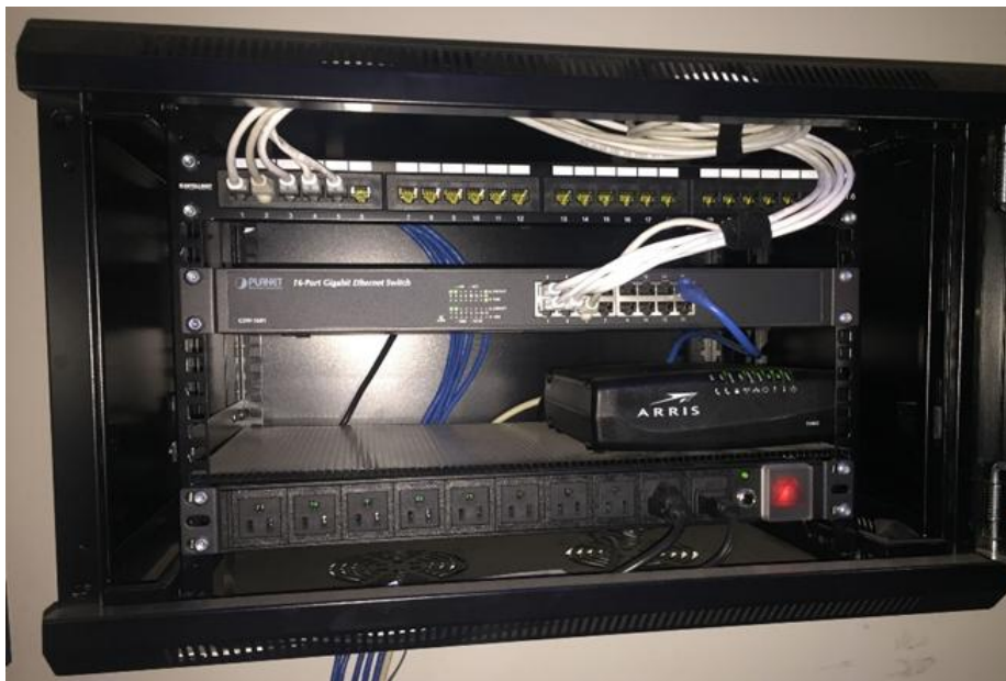
Figura 29: Gabinete del cuarto de ingreso de servicios
