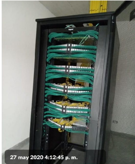
Figura 31: Gabinete de telecomunicaciones
