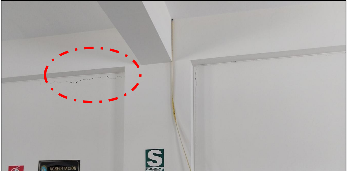
Presencia de grieta en el encuentro de tabiquería y viga principal en el 2do piso
