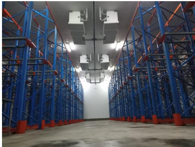
FIGURA 18. UNIDADES EVAPORADORAS DE LA CAMARA DE FRIO
