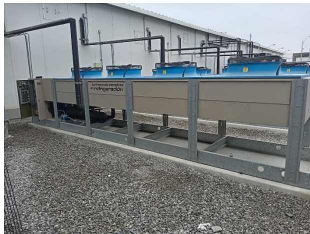
FIGURA 16. UNIDAD CONDENSADORA DEL SISTEMA DE FRIO
