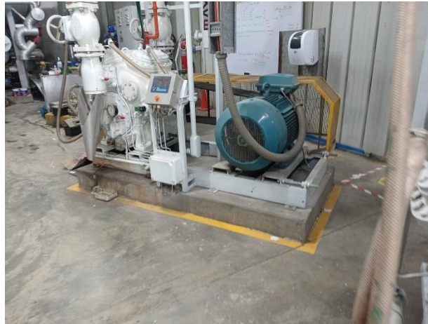
FIGURA 14. COMPRESOR DE PISTON DE LA PLANTA
