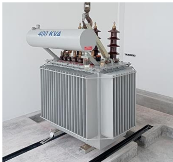
Transformador Seco 400 KVA 10KV/0.44V
