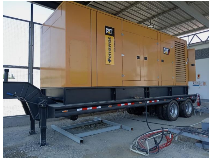
FIGURA 13. GRUPO ELECTROGENO CAT DE LA PLANTA
