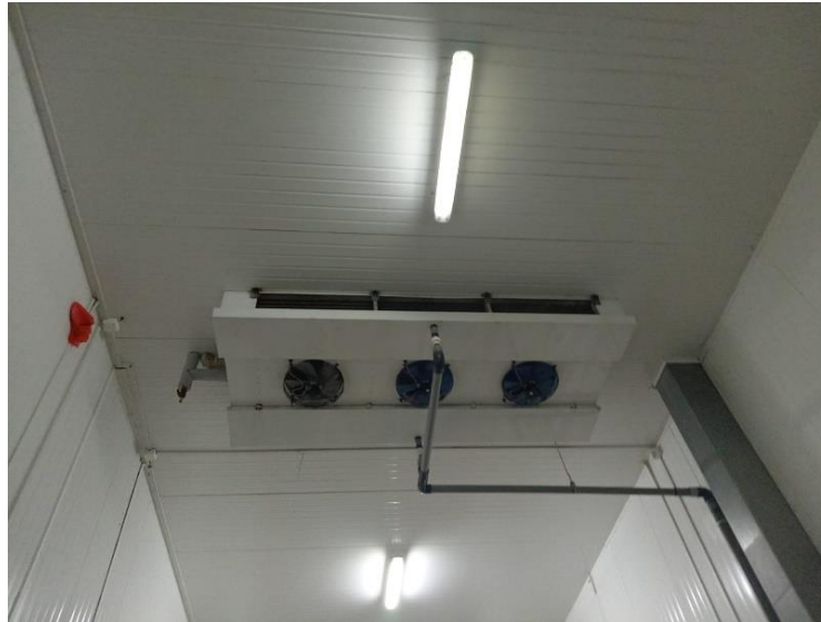
FIGURA 17. UNIDAD EVAPORADORA DE TUNELES DE FRIO
