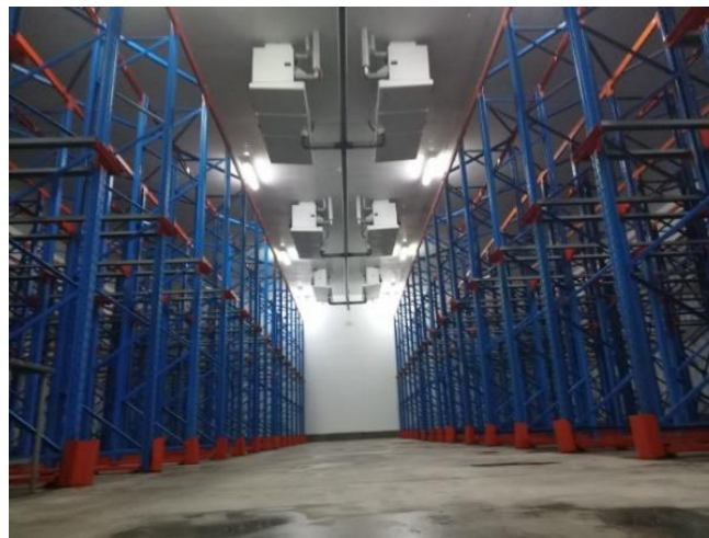
Unidad evaporadora en la cámara
