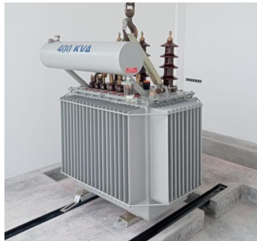
FIGURA 12. TRANSFORMADOR DE LA PLANTA
