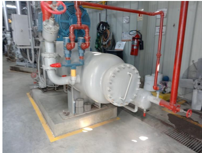
FIGURA 15. COMPRESOR DE TORNILLO DE LA PLANTA
