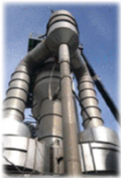
Figura 17: Planta evaporadora de agua de cola
