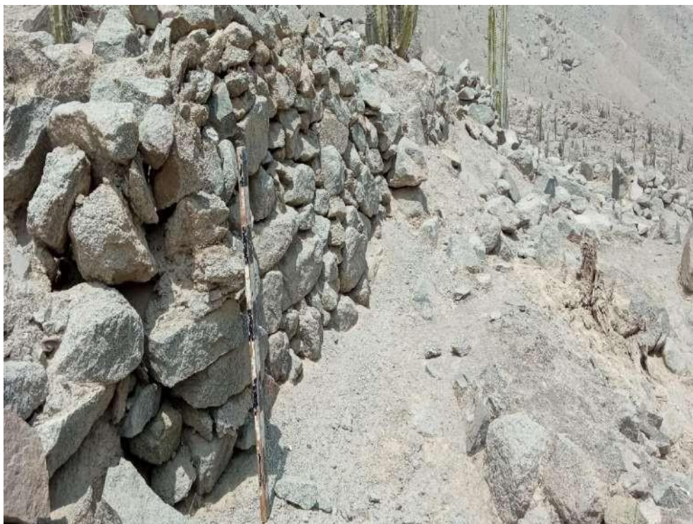
Figura 06: Vista de detalle del muro de contención emplazado en el sector 1” A” (Sandro Huamani Salazar).
