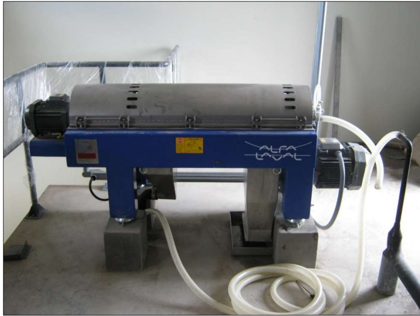
Centrífuga – Sala de deshidratación
