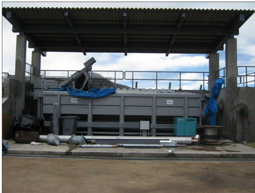
Equipo Compacto – Tratamiento Primario
