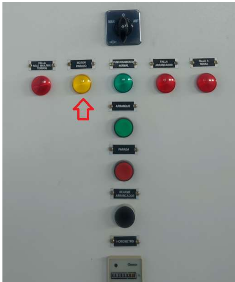
Piloto de Motor Parado del Tablero de Electrobomba
