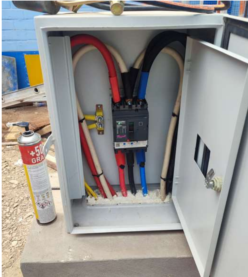
Fig. 11 Interruptor General en Baja Tensión de la Sub Estación Eléctrica Biposte
