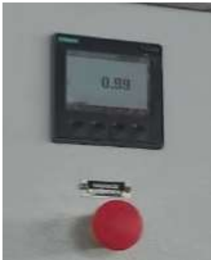
MEDICIÓN FACTOR DE POTENCIA CORREGIDO ELECTROBOMBA 1
