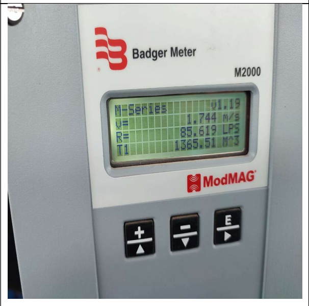
MEDICIÓN CAUDAL DE LINEA ELECTROBOMBA 2
