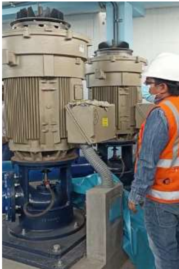
Pruebas SAT Local Funcionamiento del Sistema de Bombeo – Estación R-01
