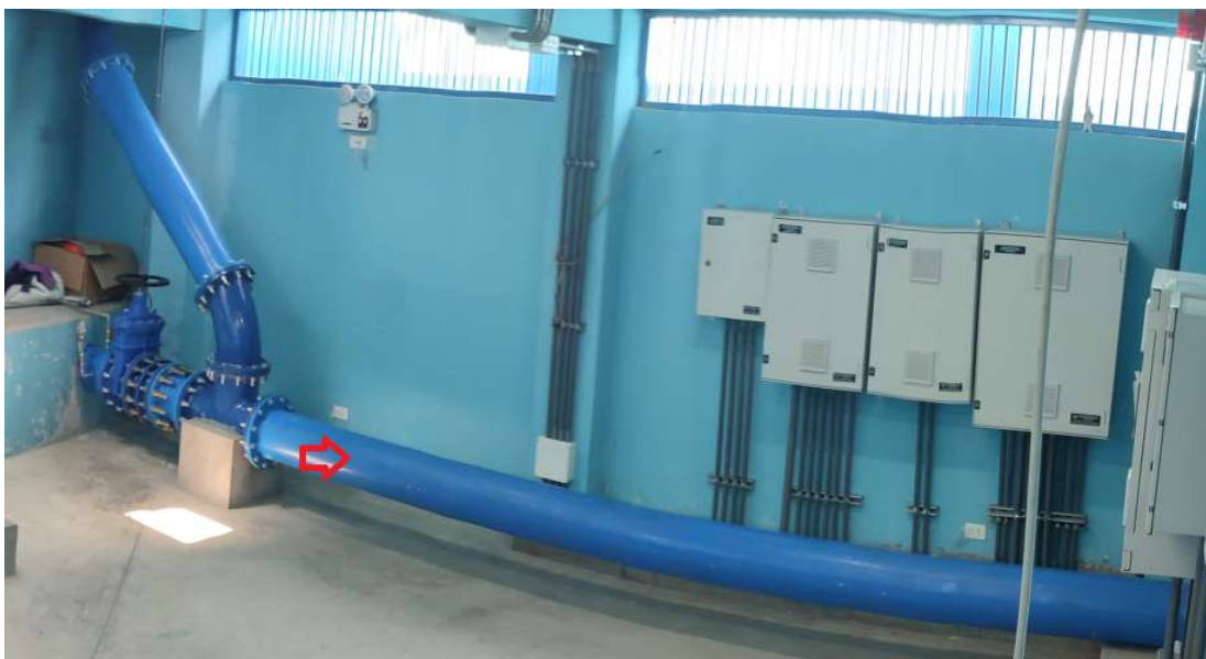
Línea de Limpia y Rebose de la Estación RP-02
