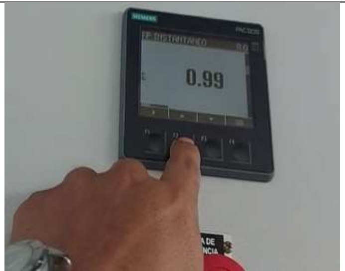
MEDICIÓN FACTOR DE POTENCIA CORREGIDO ELECTROBOMBA 2
