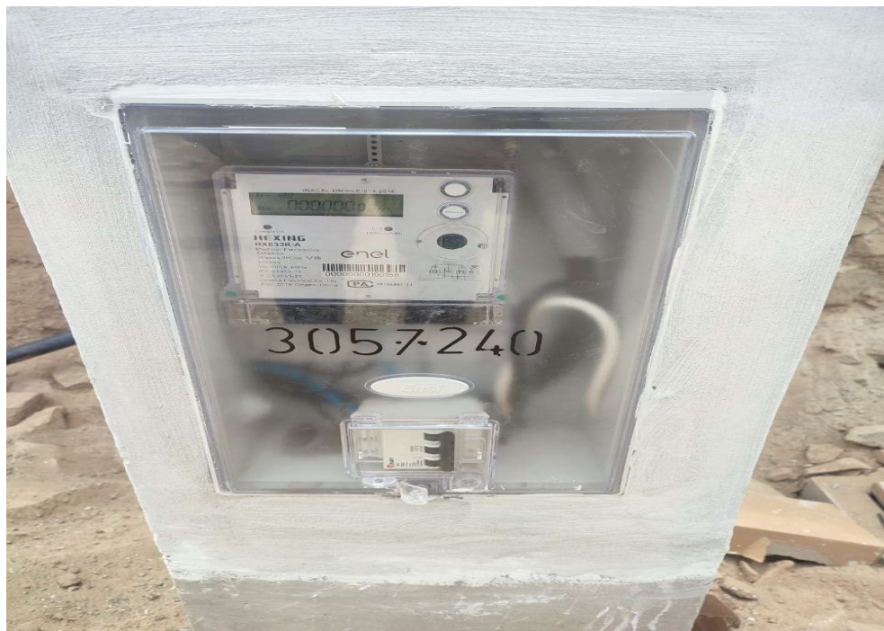
Suministro Eléctrico en Baja Tensión - Estación RP-02
