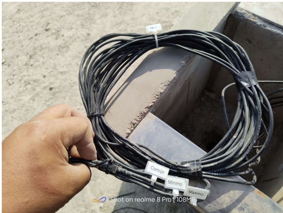
Electrodos de nivel ubicados en cúpula de reservorio R-01
