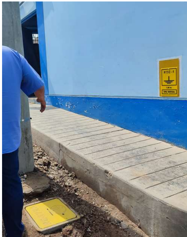
Fig. 17 Señalización de Pozo a Tierra
