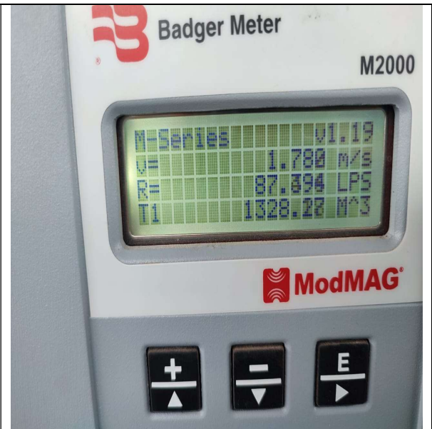
MEDICIÓN CAUDAL DE LINEA ELECTROBOMBA 1
