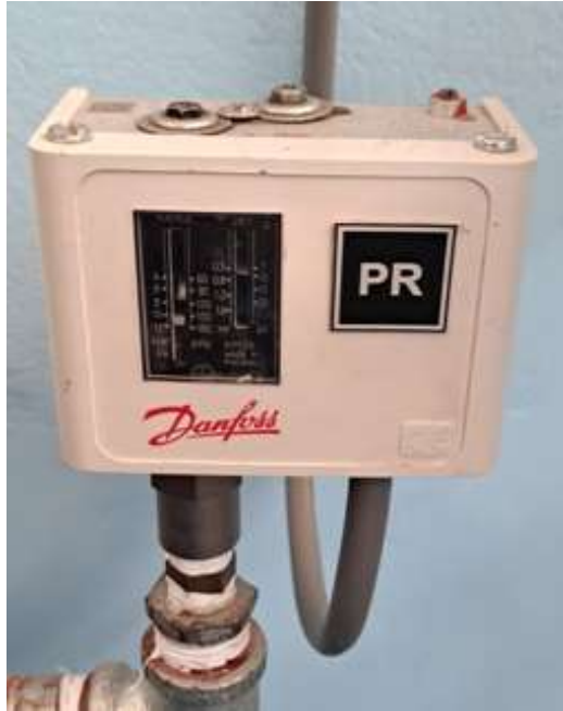
Presostato Electromecánico en Línea de Impulsión
