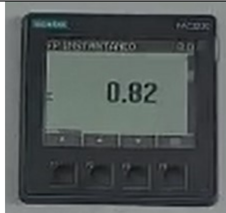
MEDICIÓN FACTOR DE POTENCIA REAL ELECTROBOMBA 2
