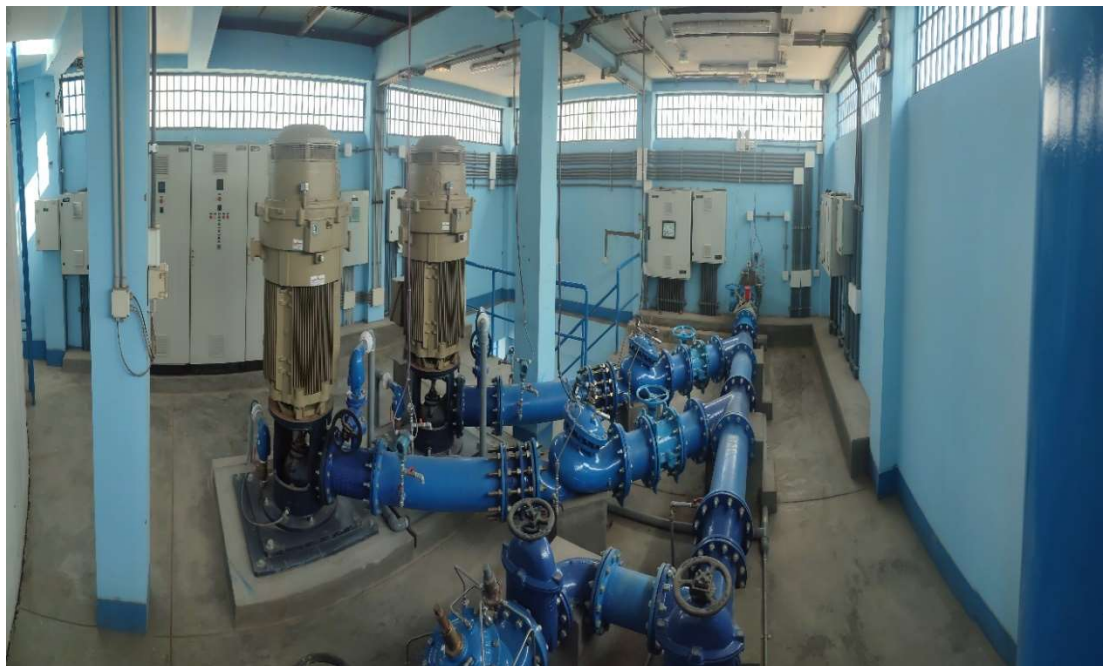
Fig. 7 Equipos de Bombeo junto equipamiento eléctrico y electromecánico instalados – Estación R-01
