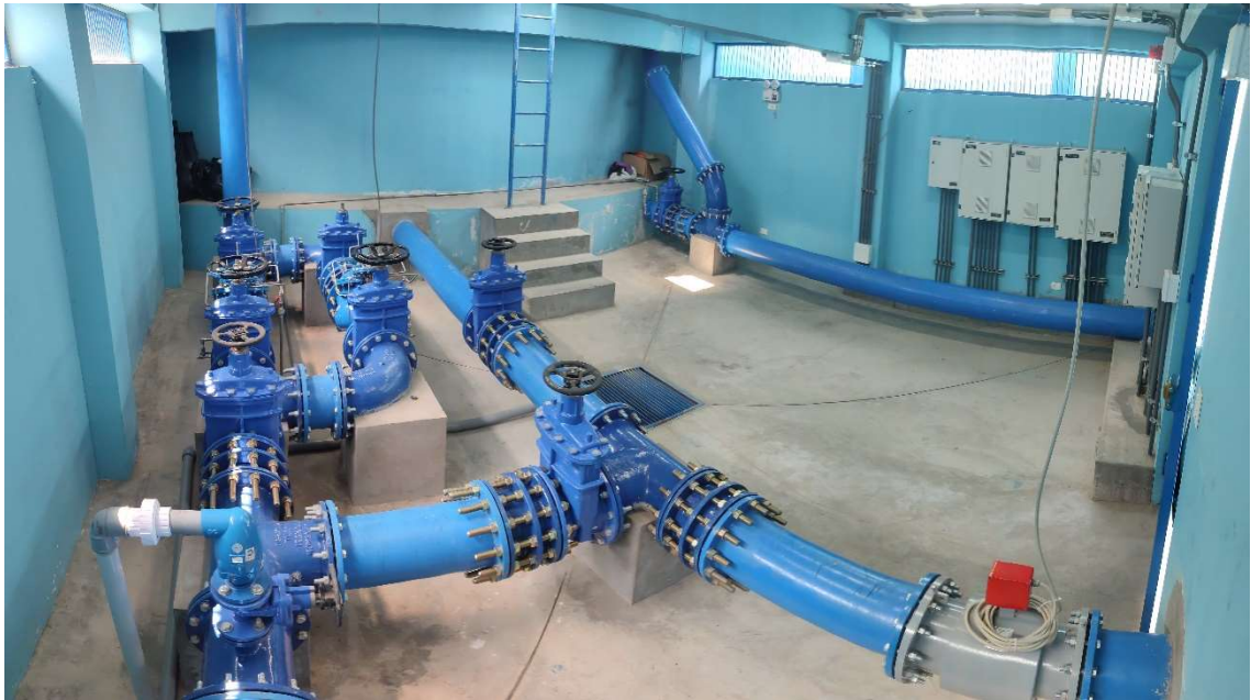
Equipamiento Hidráulico y Electromecánico - Estación RP-02
