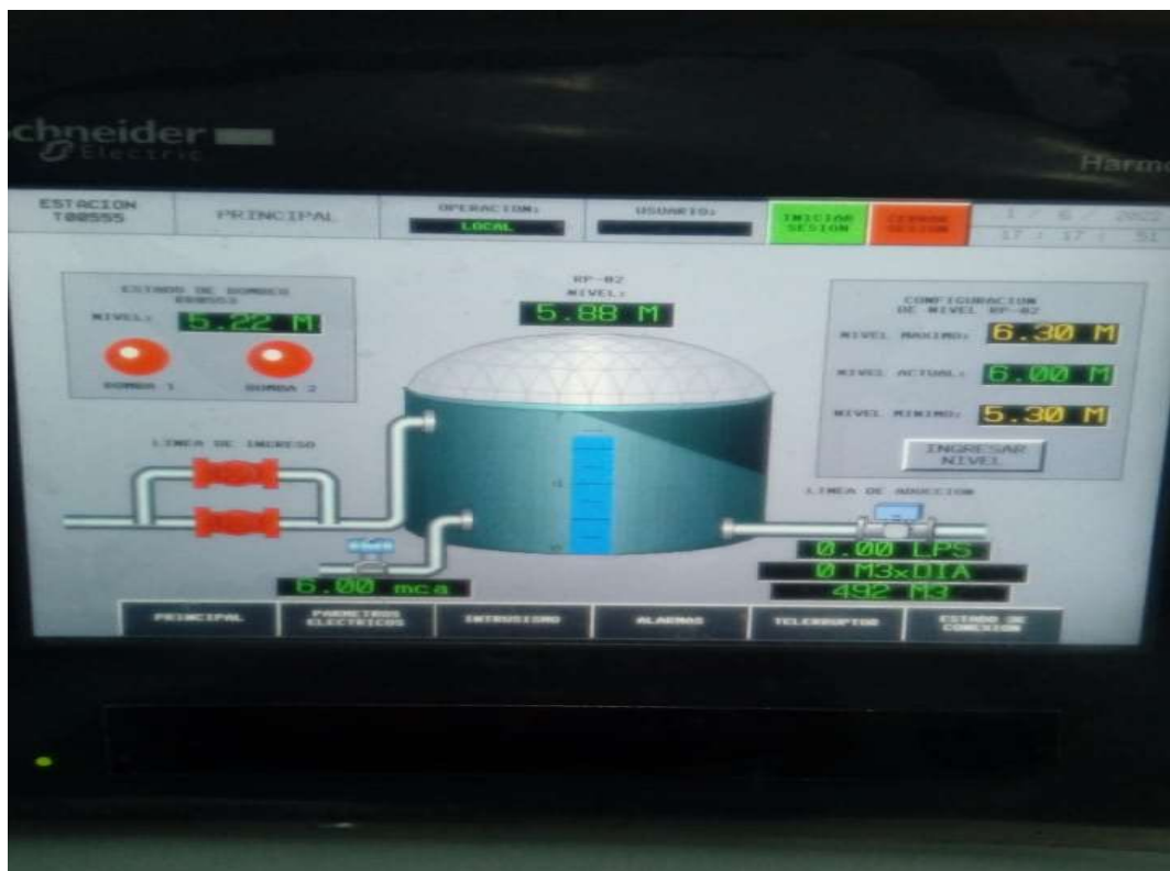
Lectura de Nivel de Agua de la Estación RP-02
