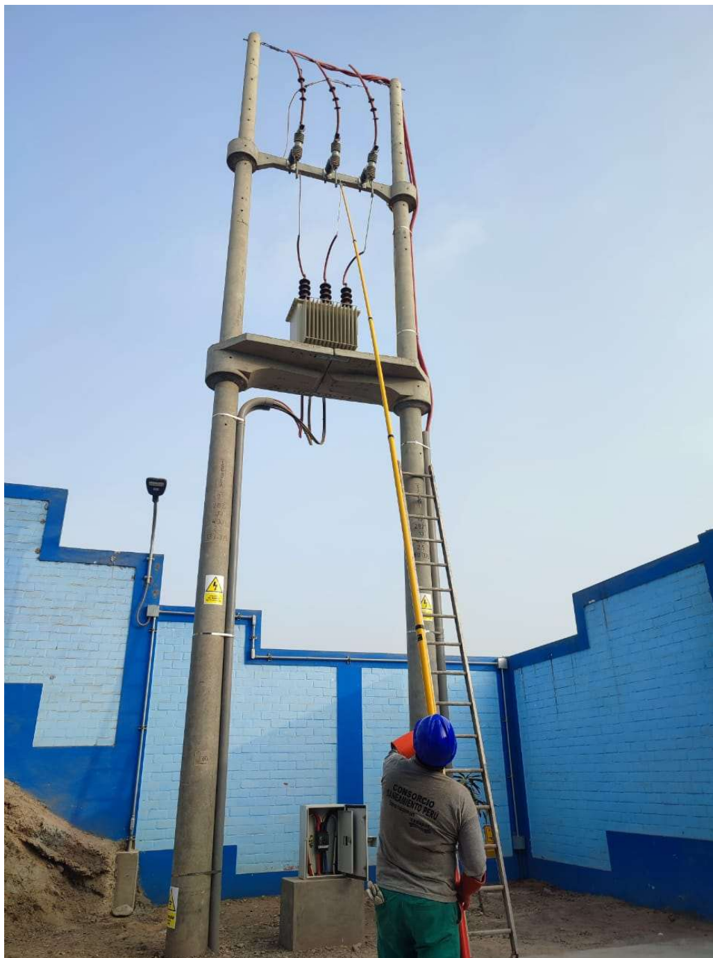
Fig. 10 Transformador en aceite de 160kVA en subestación aérea biposte instalado - Estación R-01
