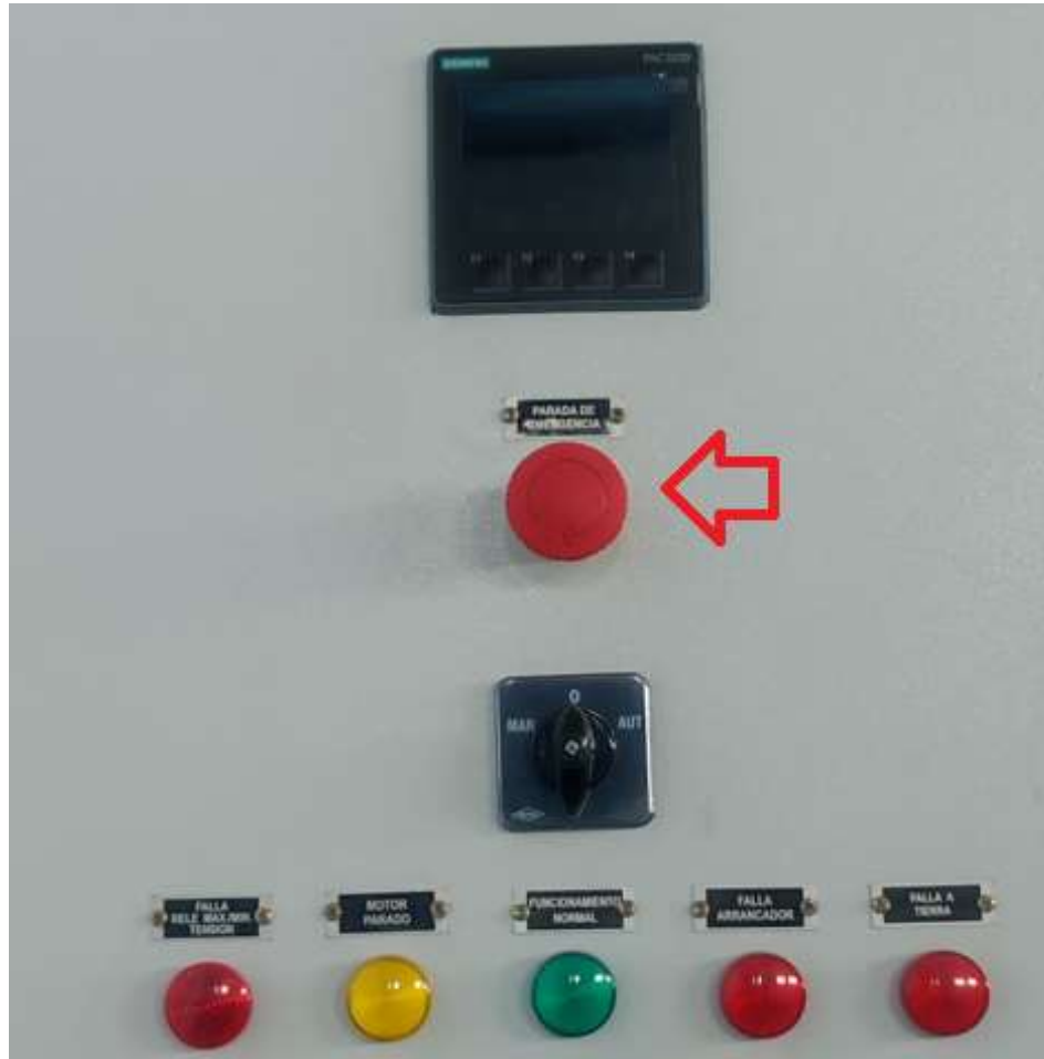
Pulsador de Parada de Emergencia del Tablero de Electrobomba
