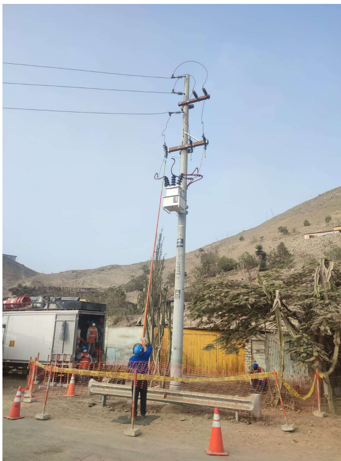
Fig. 8 Puesta en servicio de suministro eléctrico en media tensión por parte de ENEL DISTRIBUCION PERU - Estación R-01
