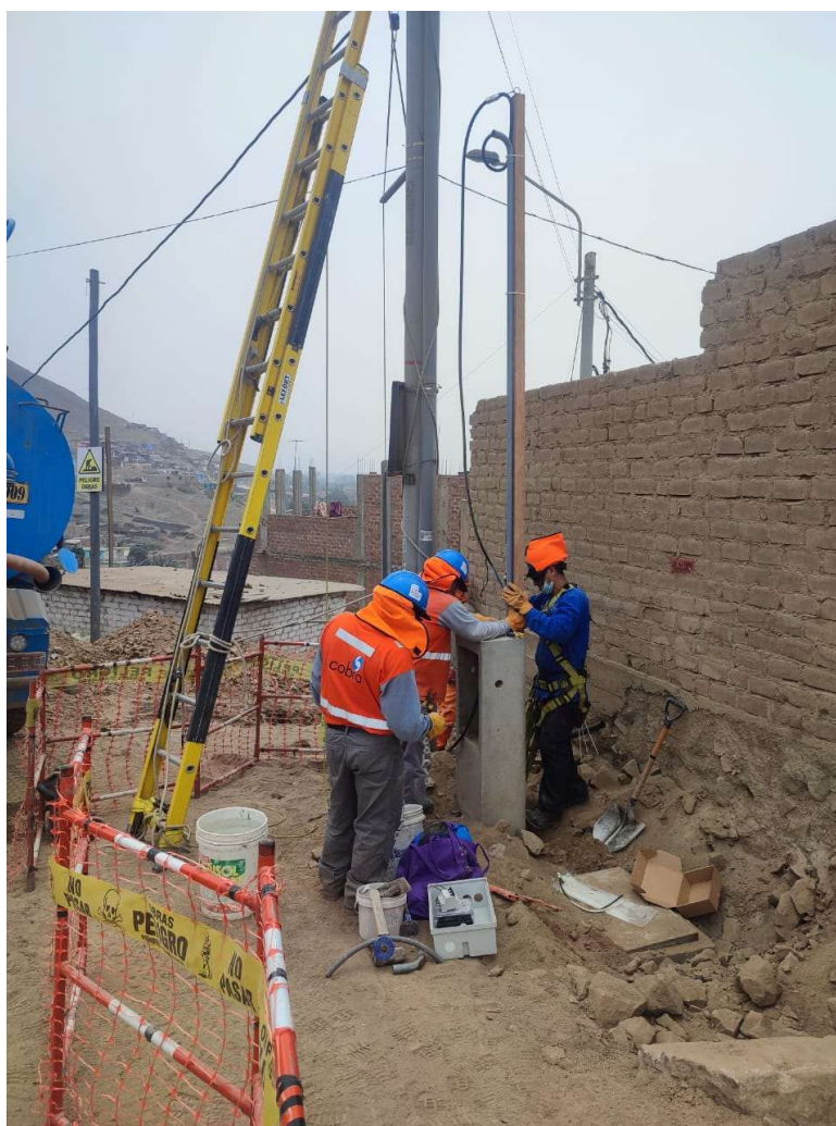
Fig. 9 Puesta en servicio de suministro eléctrico en baja tensión por parte de ENEL DISTRIBUCION PERU - Estación RP-02
