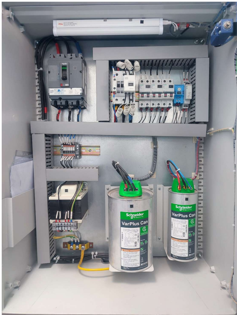
Fig. 14 Interruptor General y Condensadores en Tablero de Banco de Condensador
