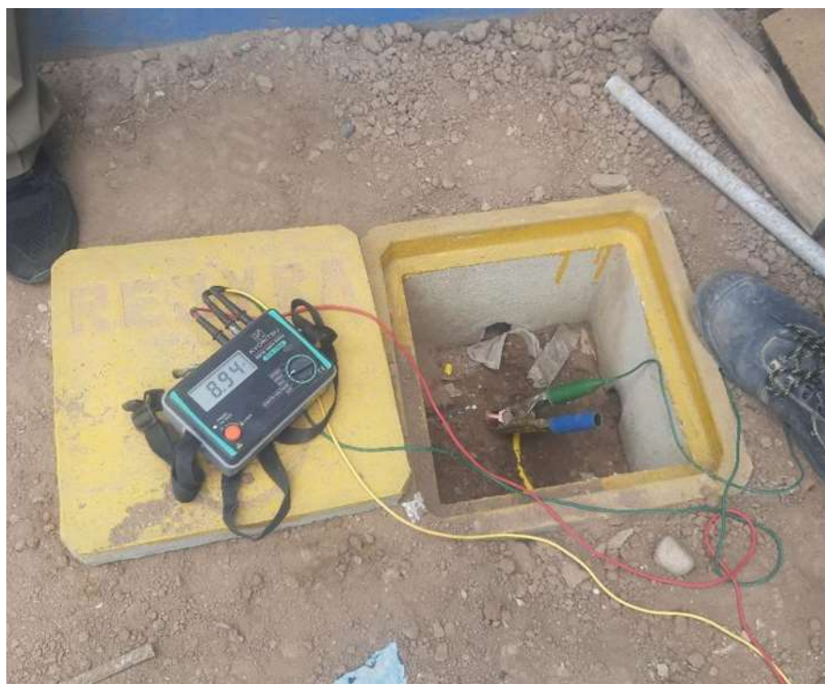
Fig. 19 Medición de Pozo a Tierra del Sistema de Fuerza con Telurómetro calibrado
