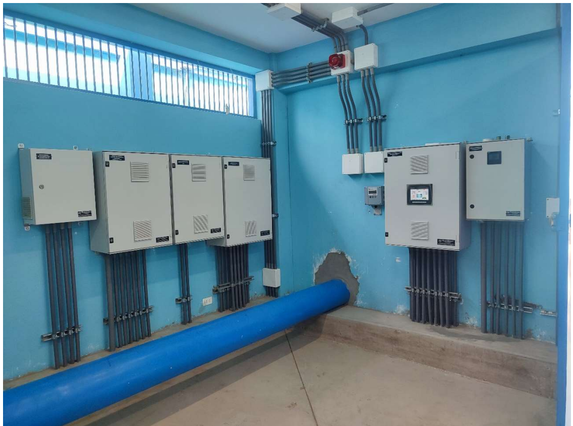
Fig. 16 Instalaciones Eléctricas en Estación RP-02
