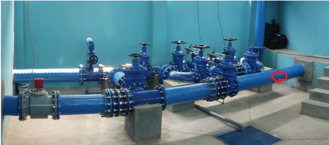
Línea de Aducción de la Estación RP-02
