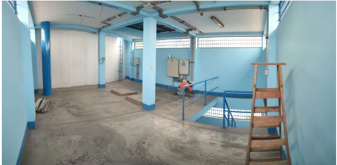
Fig. 6 Estación R-01 sin equipamiento eléctrico y electromecánico
