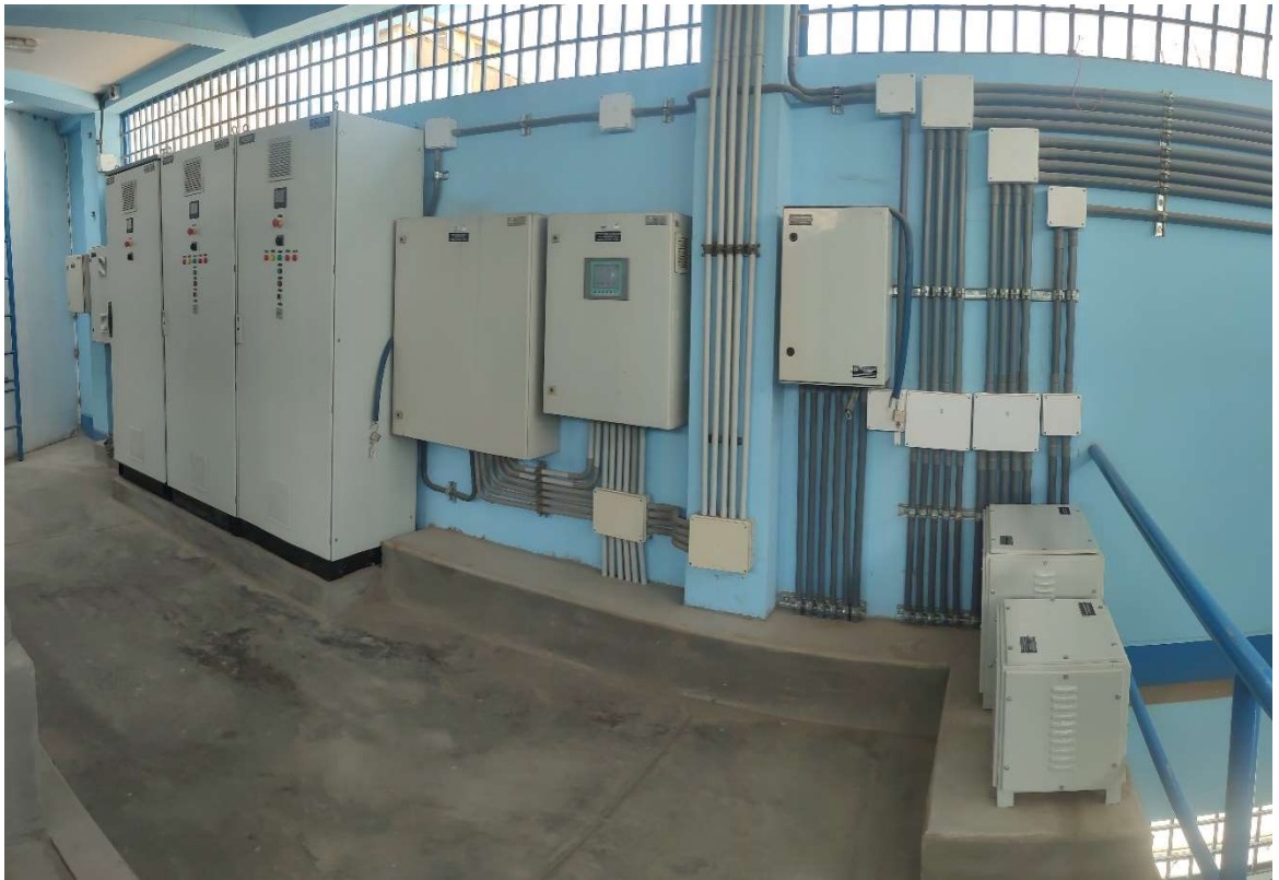
Fig. 15 Instalaciones Eléctricas en Estación R-01
