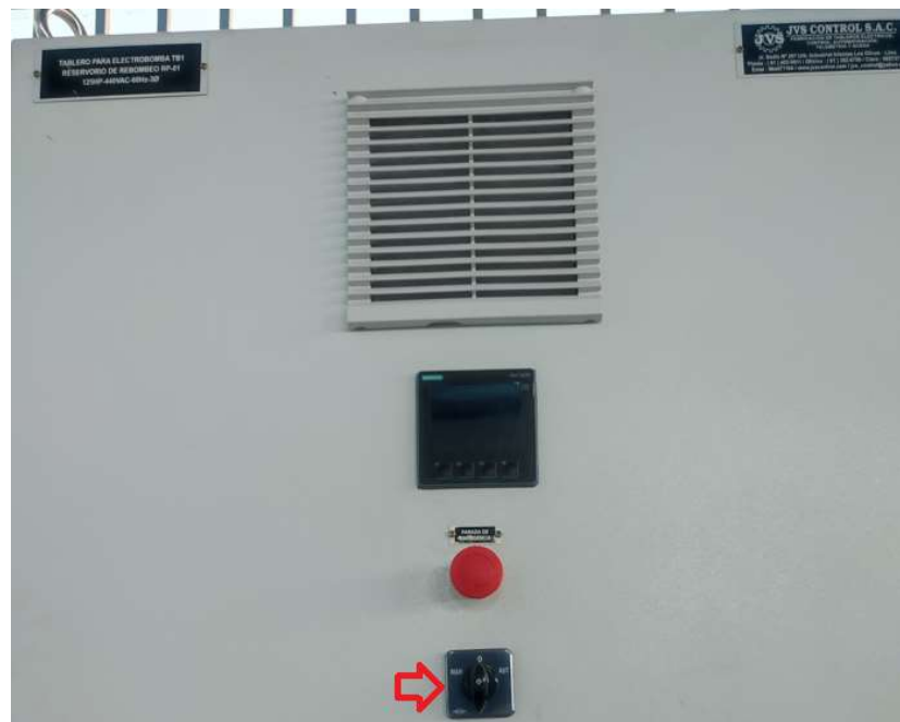
Selector MoA (Manual – 0 – Automático) del Tablero de Electrobomba
