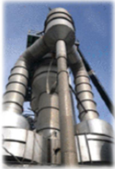
Figura 17: Planta evaporadora de agua de cola
