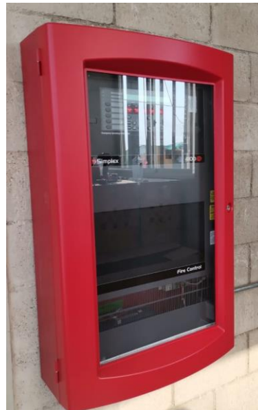
Fig. 199: Panel contra incendios SIMPLEX4100 (garita ingreso)
