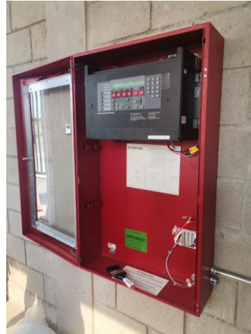
Fig. 966: Montaje de tarjetas y pantalla principal
