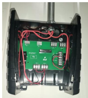
Fig. 682: Cableado del controlador hacia el detector
