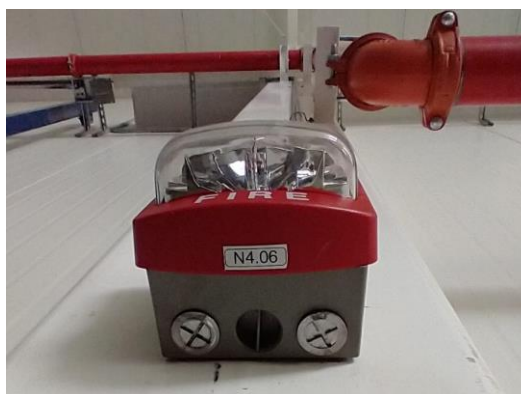
Fig. 858: Instalación de sirenas con luz estroboscópicas
