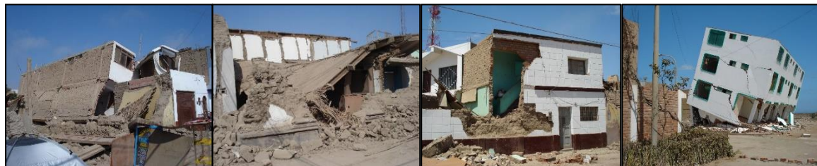
Figura 2. Derrumbe de edificaciones / estructuración deficiente de columnas.
