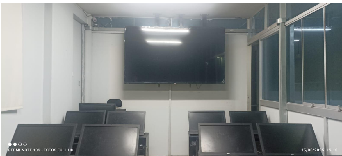
Fig. 66. Verificando la conectividad de red de la televisión y de la cámara instaladas en el aula 401.
