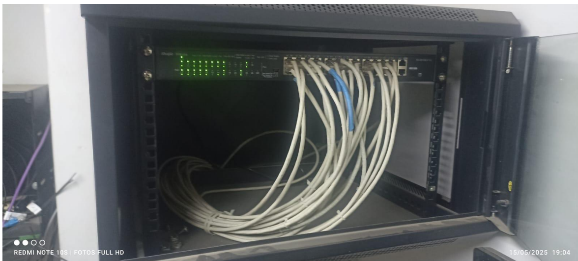
Fig. 60. Estado Switch de cámaras
