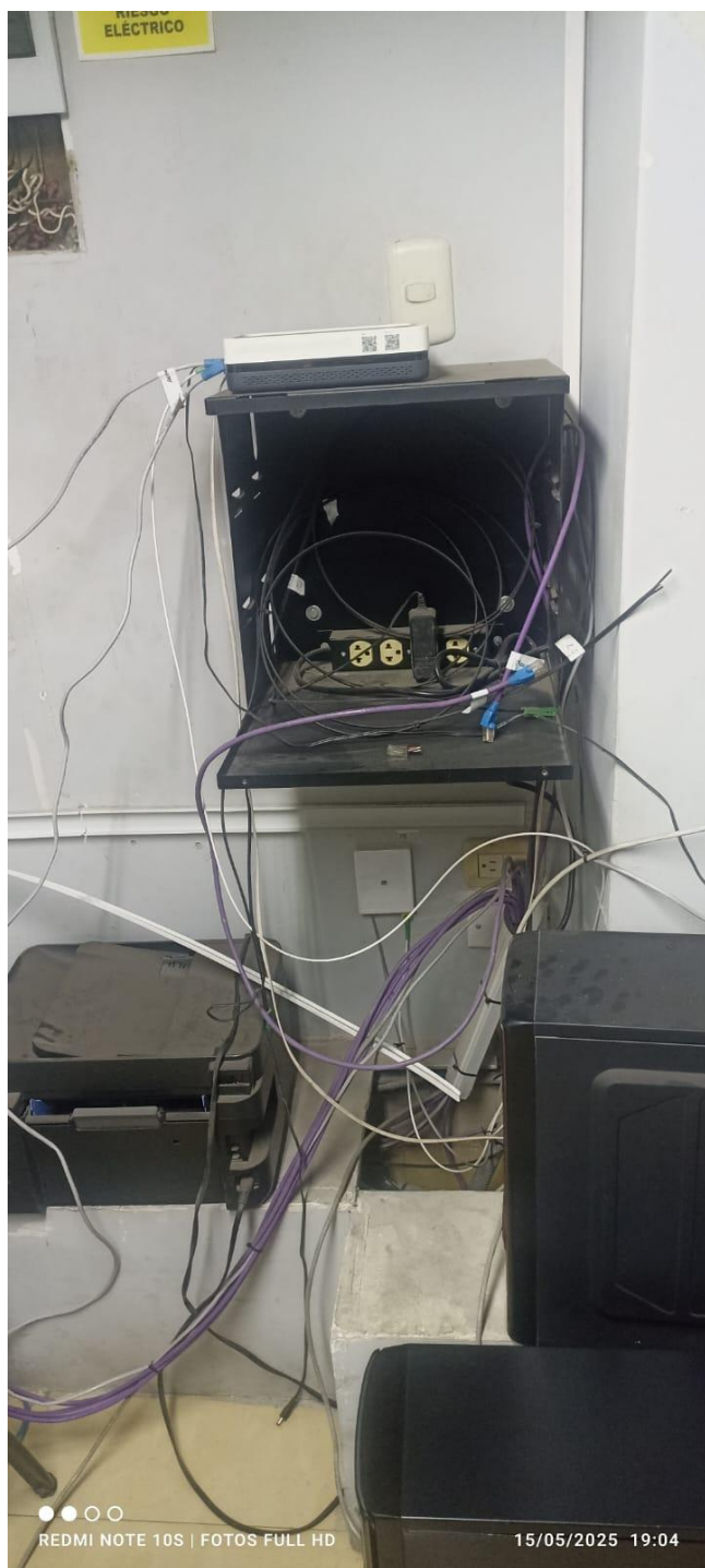
Fig. 59. Estado gabinete de pared
