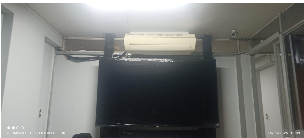
Fig. 64. Validando la conectividad de red de la televisión y de la cámara instaladas en cada aula.
