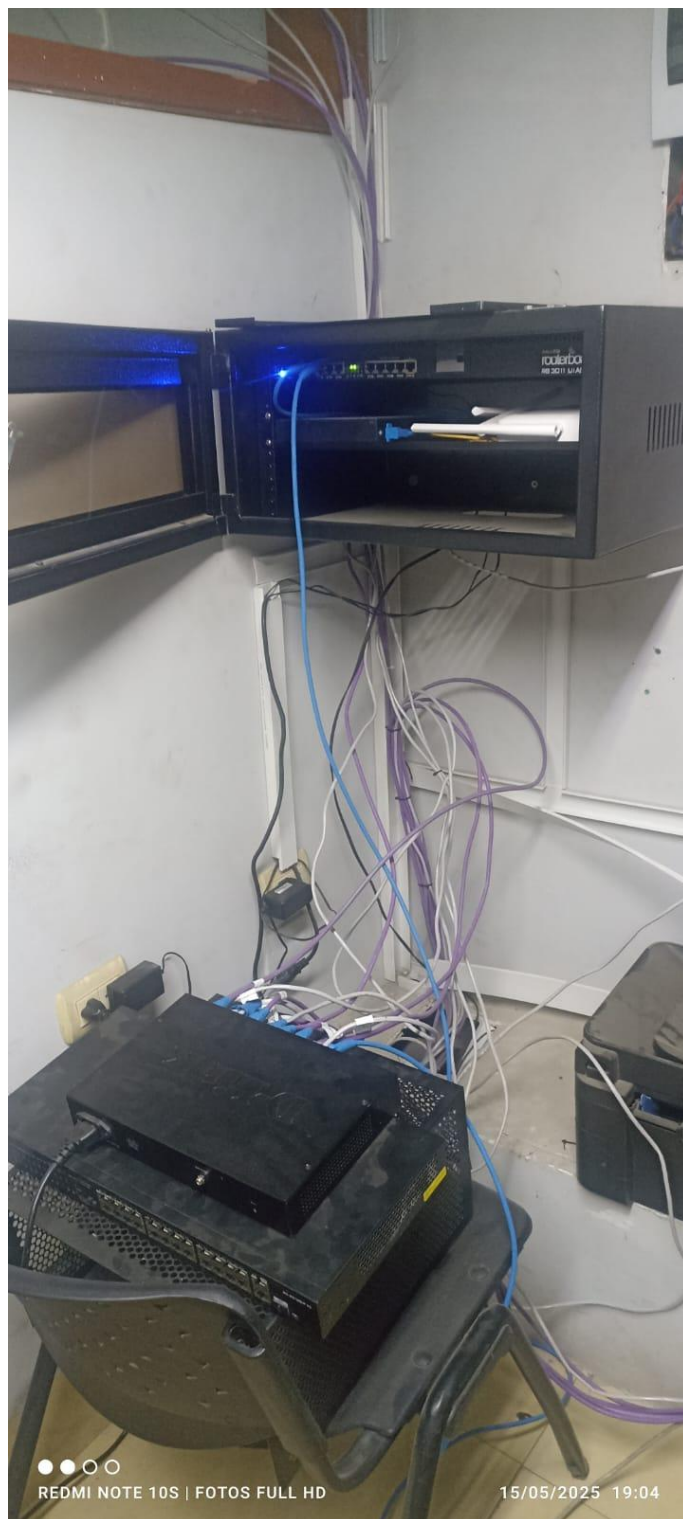
Fig. 71. Estado gabinete principal
