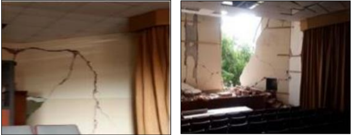
Fig. 2. Falla por paredes demasiado altas [2]
