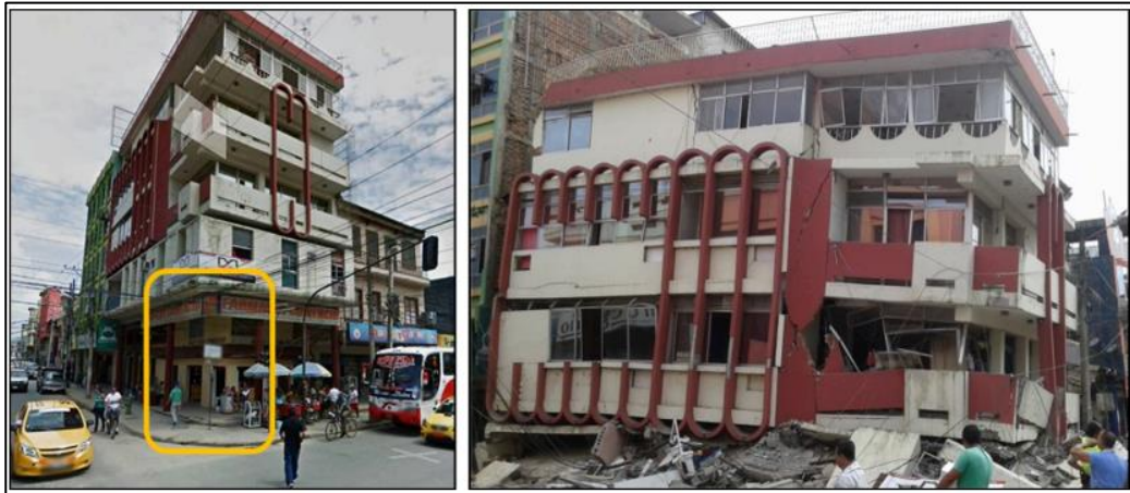
Fig. 1. Falla por Ausencia de Columna en Esquina en Portoviejo Ecuador [1]
