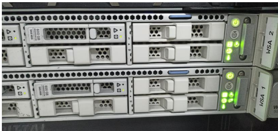
Fig. 4: Equipo Cisco instalado
