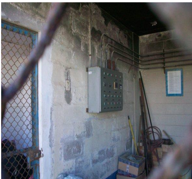
Figura 10. Vista frontal e instalación eléctrica del tablero de control del incinerador CIMELCO
