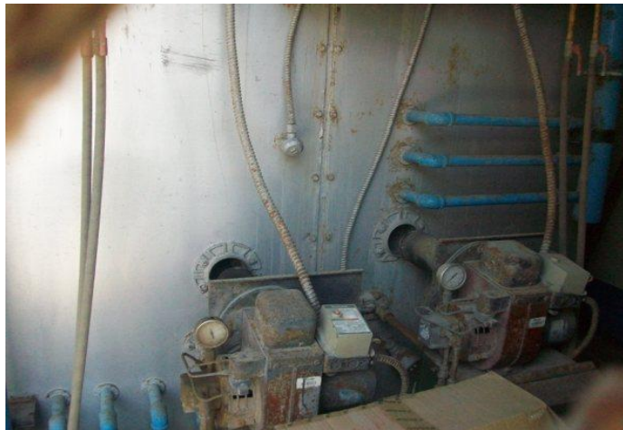
Figura 8. Vista lateral derecha del incinerador CIMELCO quemadores de primera y segunda cámara
