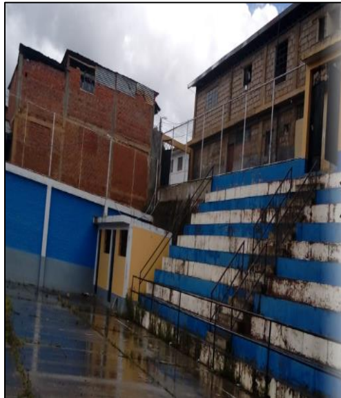
Fig. 27. Se muestra el estado de la gradería existente
