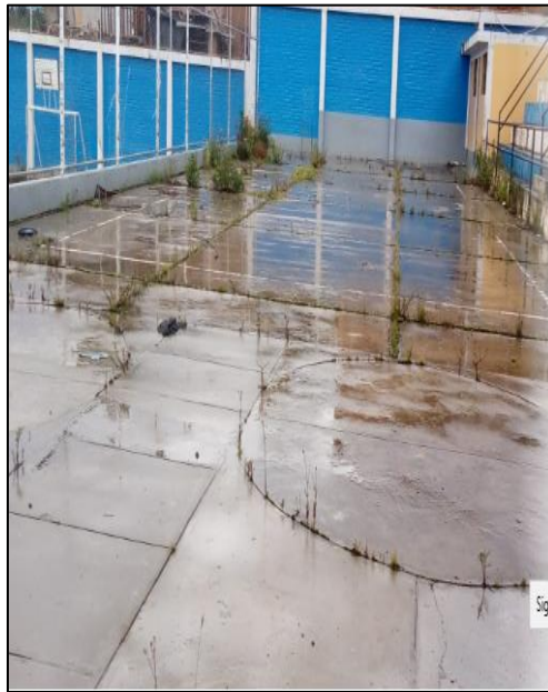
Fig. 23. Se muestra el estado de la losa existente
