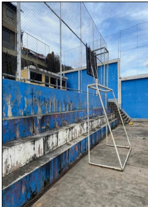
Fig. 21. Se muestra el estado de la losa existente
