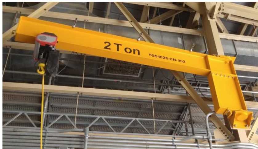
Figura 38: Montaje final de grúa pescante giratoria Cap. 2 Ton
