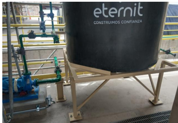
Figura 29: Montaje final del sistema de agua recuperada
