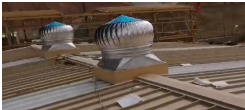
Figura 70: Montaje de extractores atmosféricos
