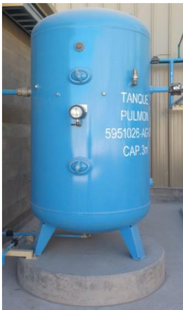
Figura 34: Tanque acumulador de cap. 3 m 3
