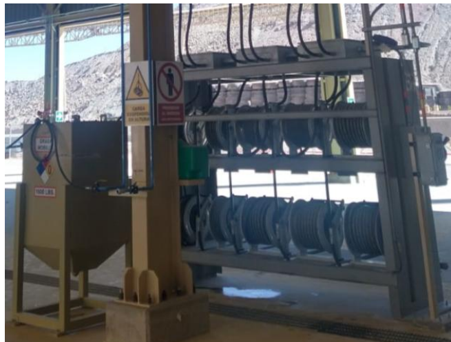
Figura 27: Montaje final de estación de lubricación y engrase 5951026-XM-007
