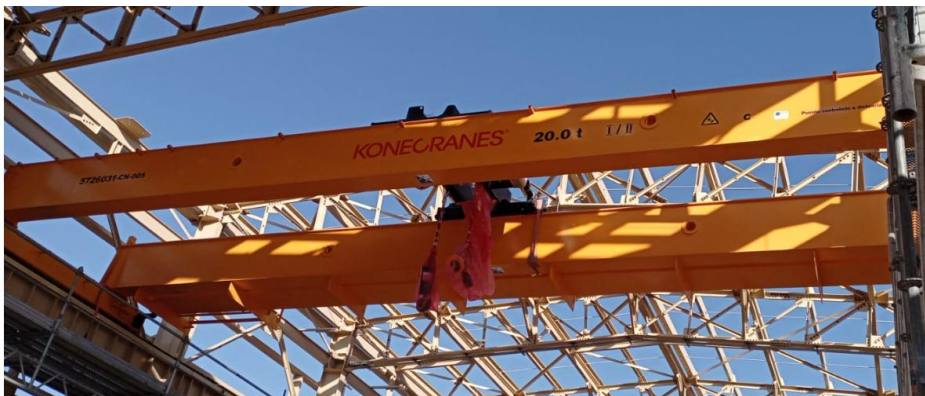
Figura 68: Presentación final del puente grúa 5726031-CN-005
