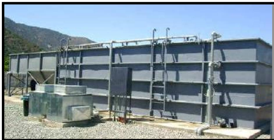
Figura 14: Planta de Tratamiento de aguas residuales en Estanque de Acero revestido
