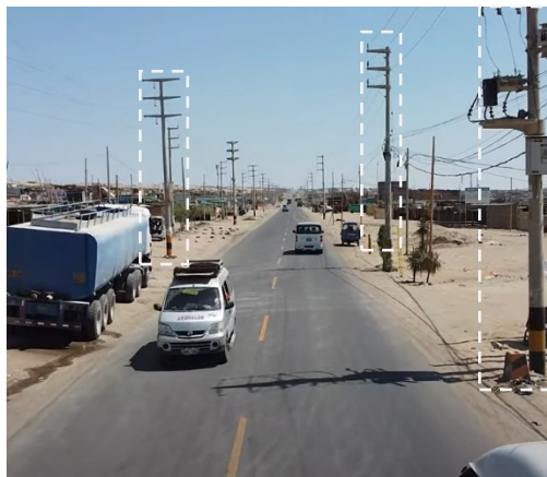
Figura 22. Infraestructura eléctrica en la vía principal - Carretera Carhuaz
