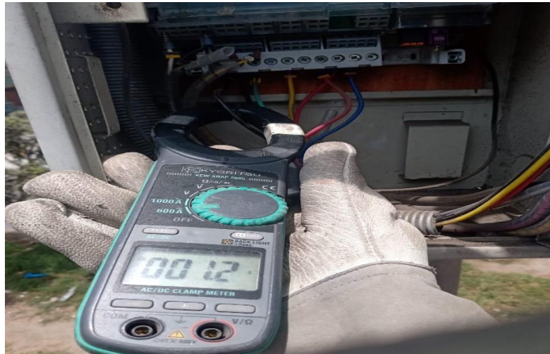
Figura 3.15: Toma de cargas en Totalizador Bobina 1
