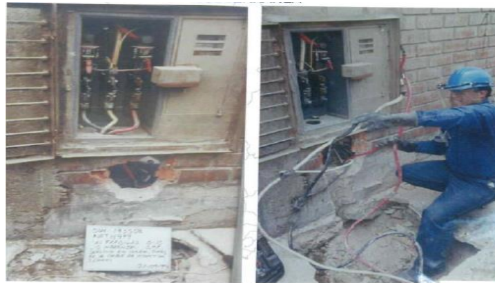
Figura 3.26: Conexión clandestina con suministro activo
