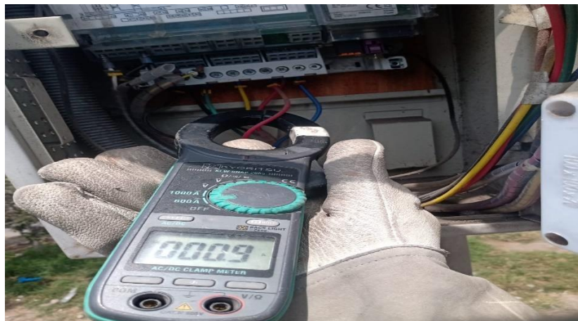
Figura 3.16: Toma de cargas en Totalizador Bobina 2
