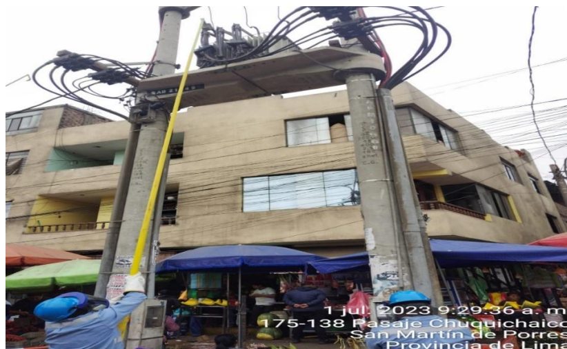
Figura 3.18: Toma de cargas en cables de comunicación de la SED
