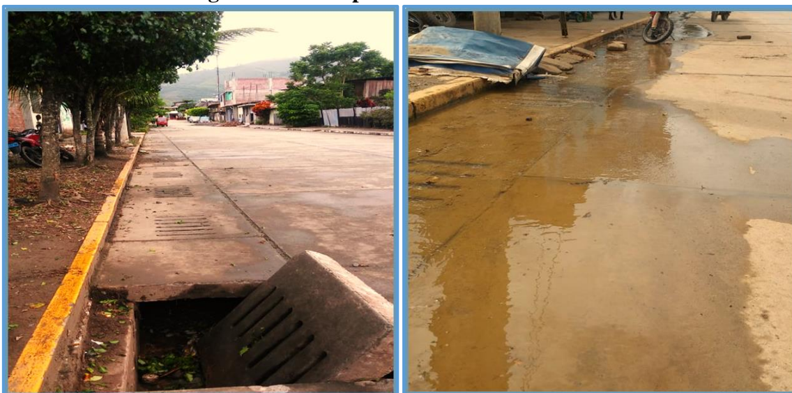
Imagen N°13: Colapso de Cuneta Sector Pichari
