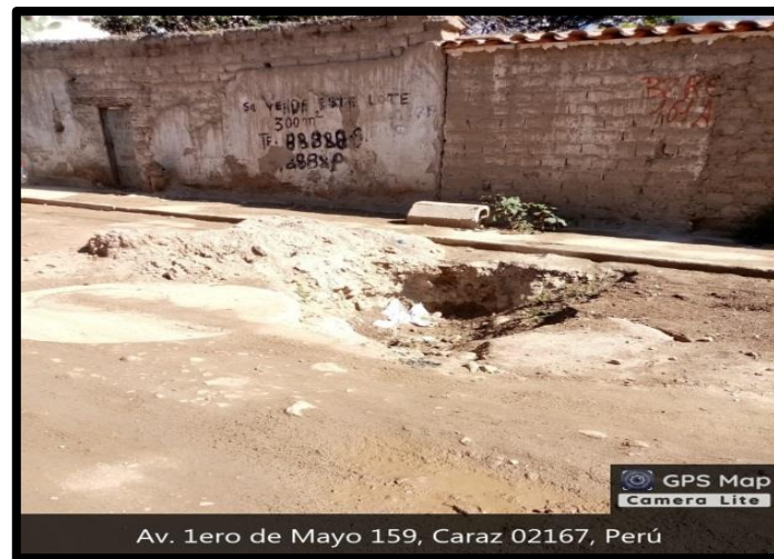
Figura N° 24: zanjas sin rellenar
