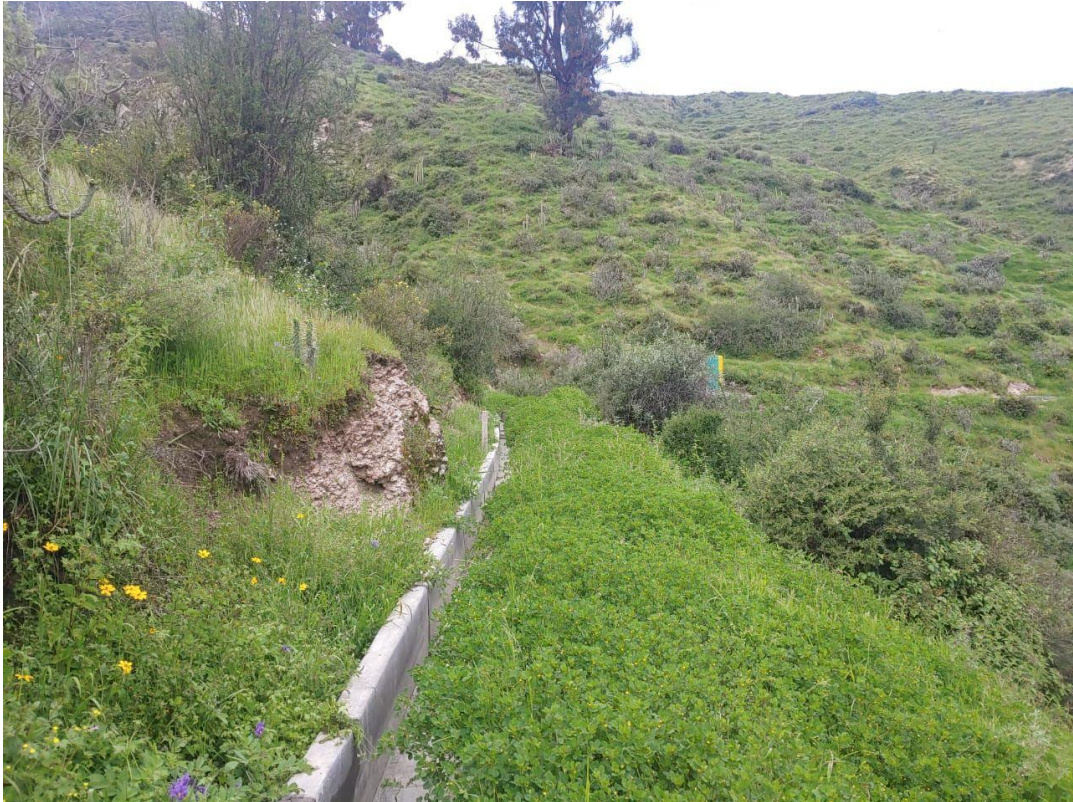
Foto 6. Excesiva vegetación en otros tramos
