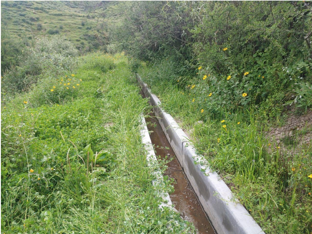
Foto 7. Excesiva vegetación en otros tramos
