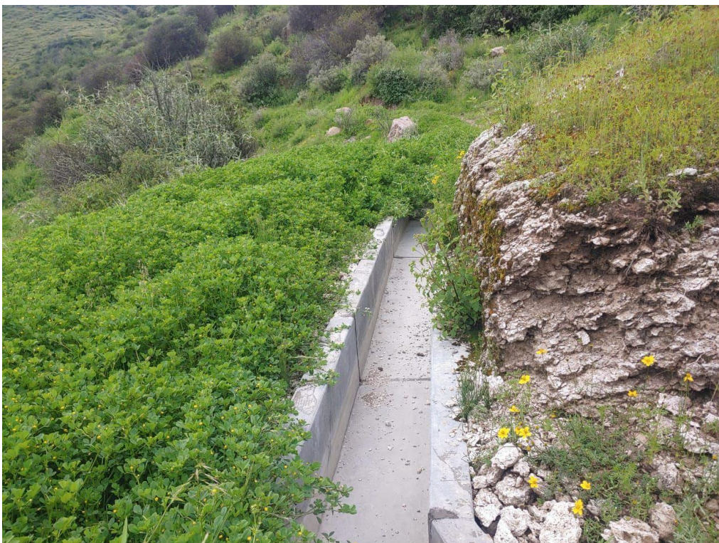
Foto 14. Posibles derrumbes en el canal
