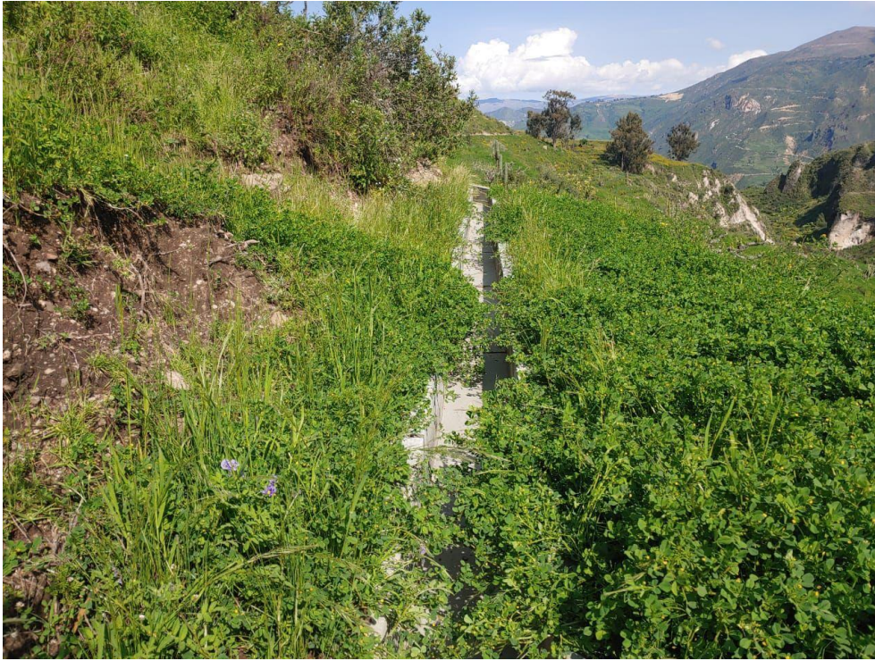
Foto 17. Presencia de vegetación y posibles derrumbes
