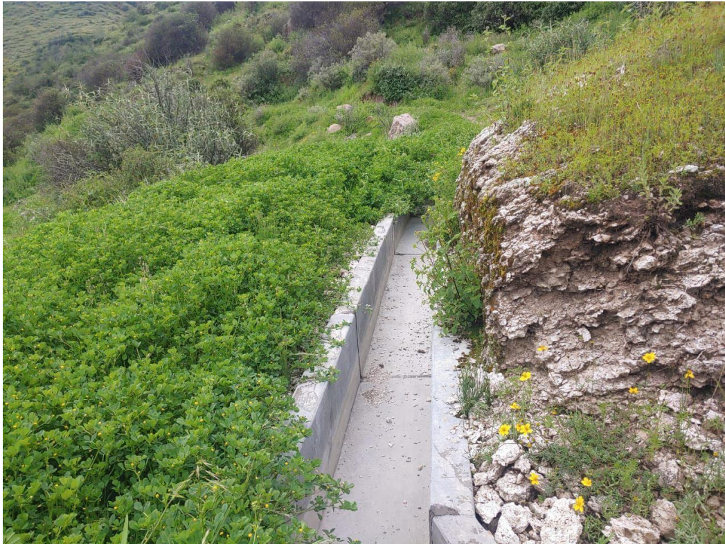
Fig. 2 Tramo 0+540 – 0+790.60, derrumbes en sus márgenes
