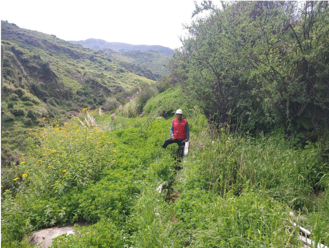
Foto 9. Excesiva vegetación en otros tramos
