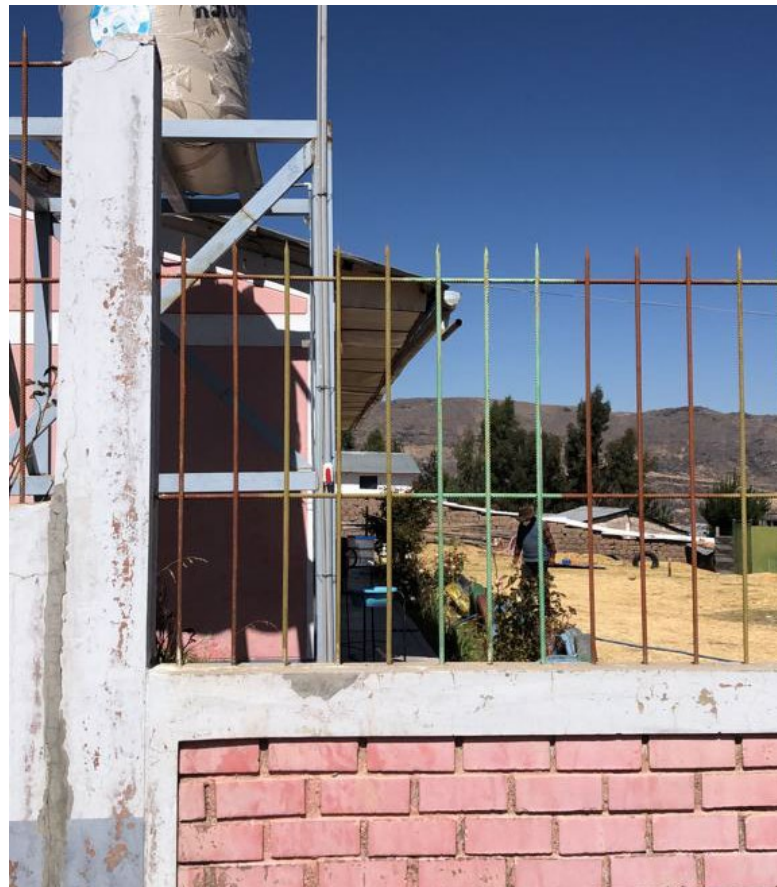
Fig. 9 Pequeñas canaletas en los techos, en mal estado y con continuos desbordes
