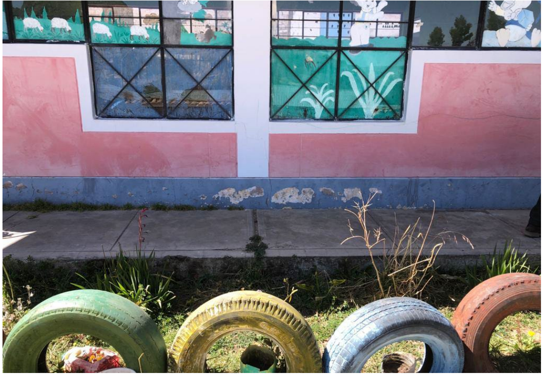
Fig. 6 Desgaste de las paredes de las aulas en el exterior de las aulas
