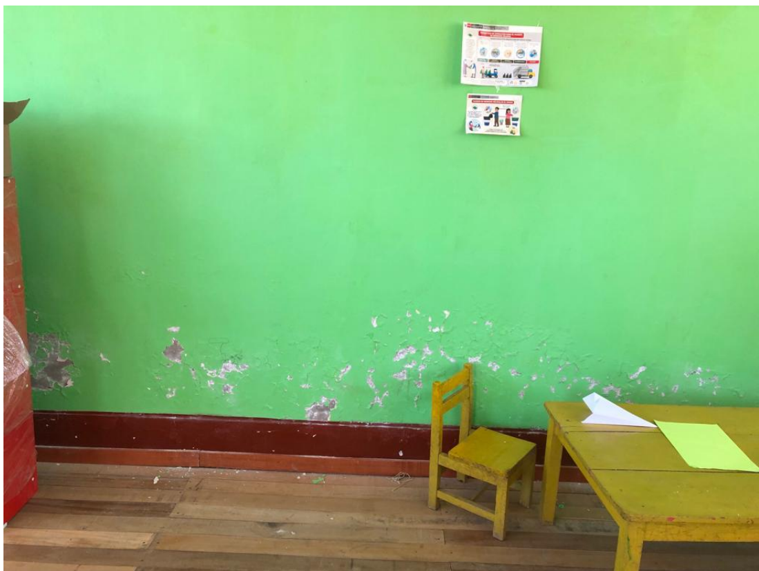
Fig. 5 Desgaste de las paredes de las aulas en el interior
