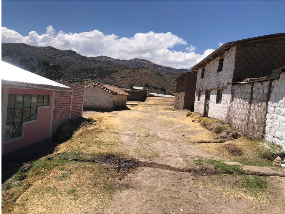
Fig. 11 Calles del C.P. de Raquina, se observa problemas a nivel de la localidad respecto a las precipitaciones
