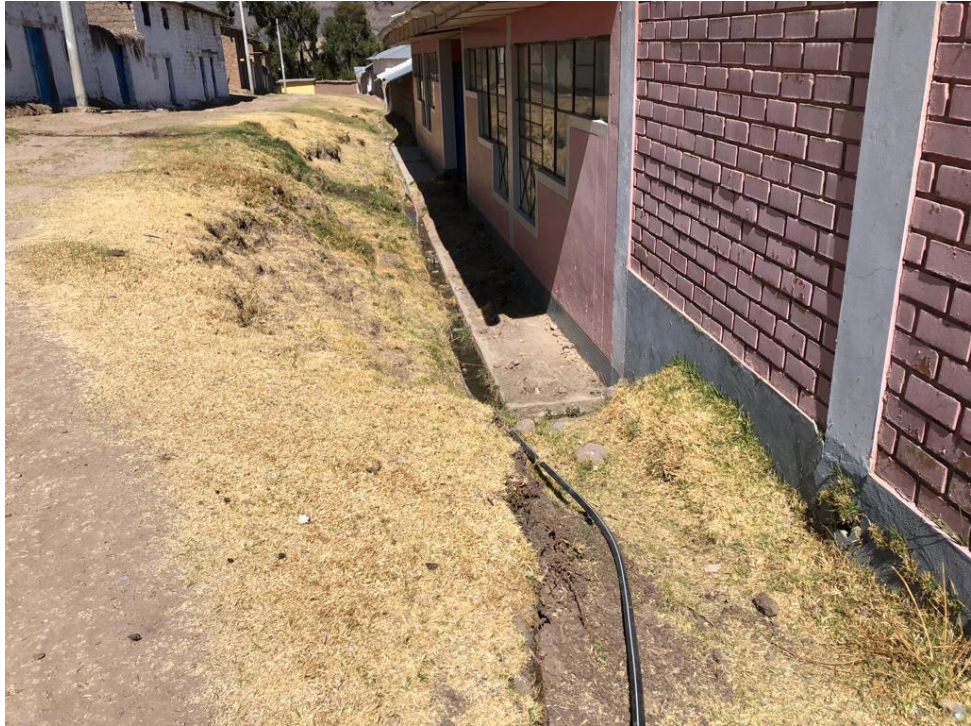
Fig. 8 Exteriores de la Institución Educativa-exceso de vegetación por precipitaciones
