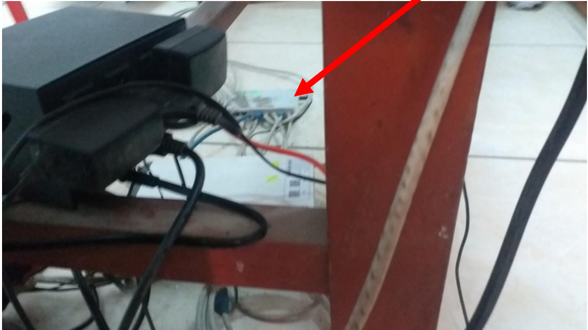
Fig. 11. Estado de los equipos de comunicaciones (Switch)
