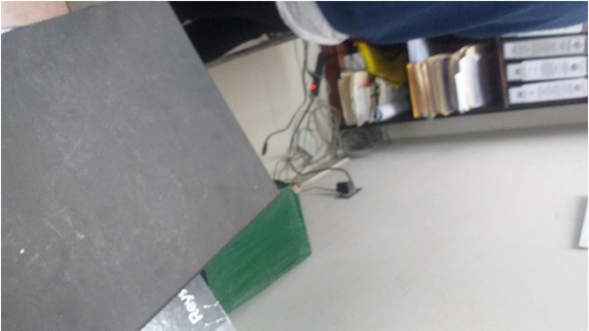
Fig. 15. Conexiones deficientes de datos y de energía
