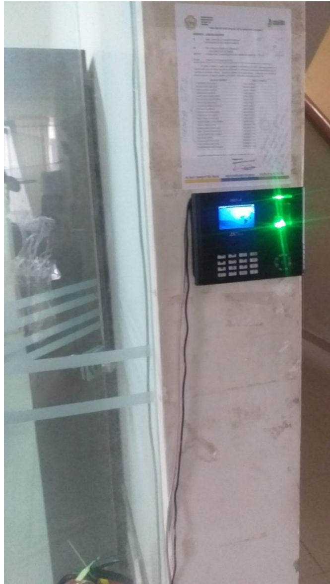
Fig. 22. Equipo de marcación de asistencia
