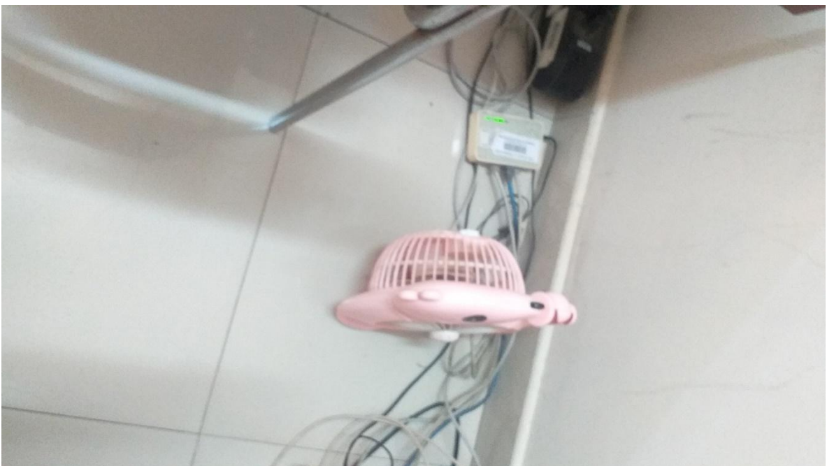
Fig. 18. Desorden en las conexiones de los equipos
