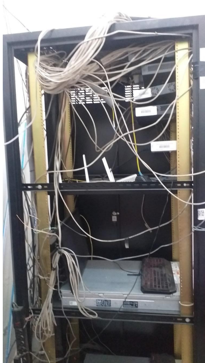
Fig. 9. Vista lateral del estado del gabinete principal
