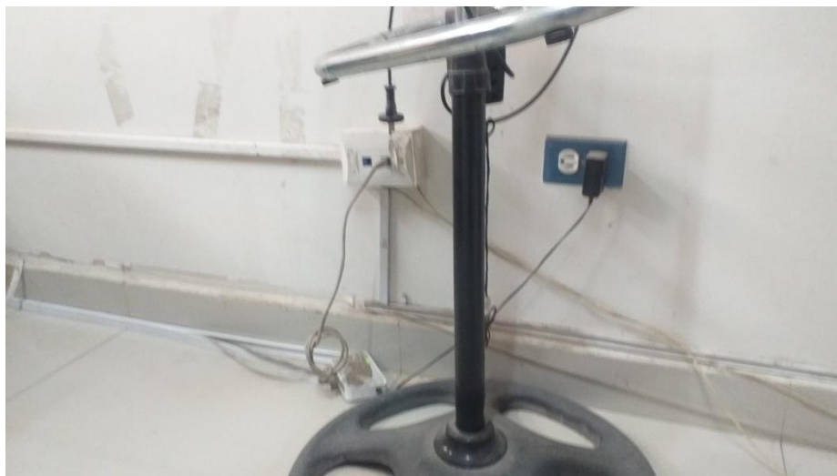
Fig. 20. Conexiones y canaletas deficientes
