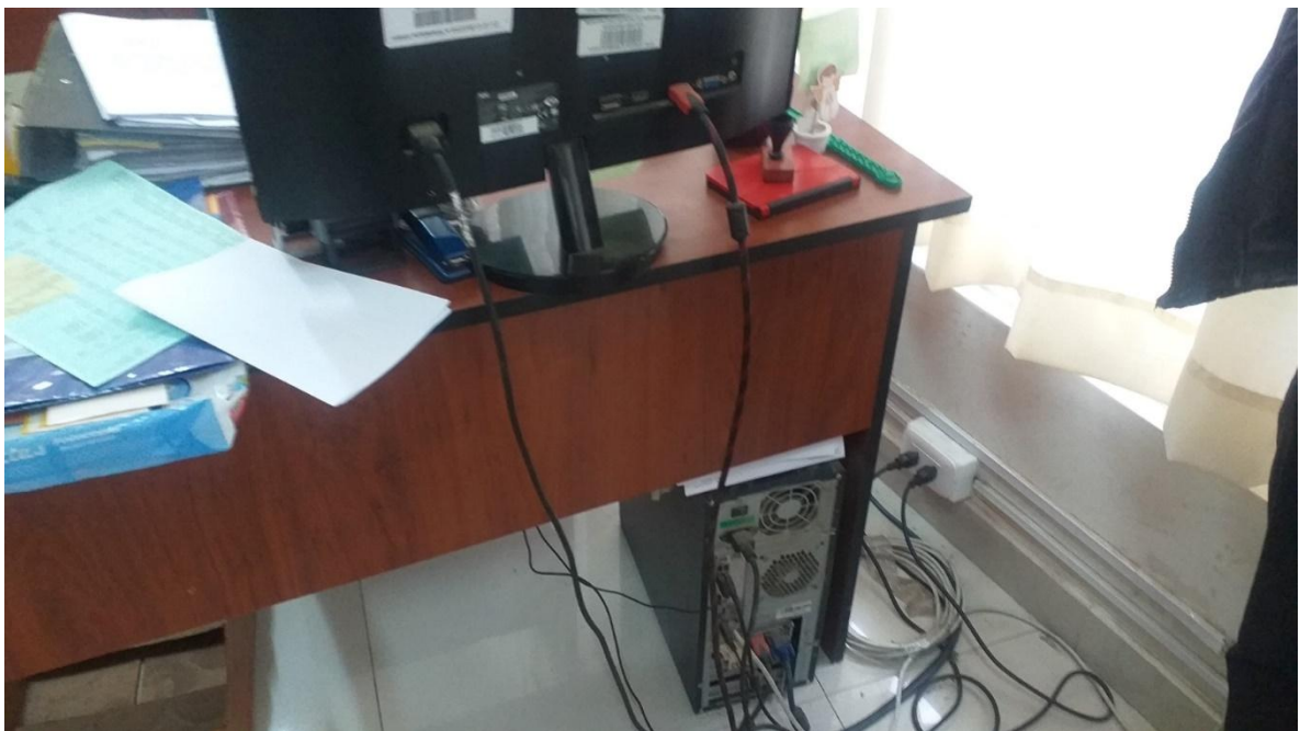
Fig. 25. Deficiencia en conexiones del área de trabajo
